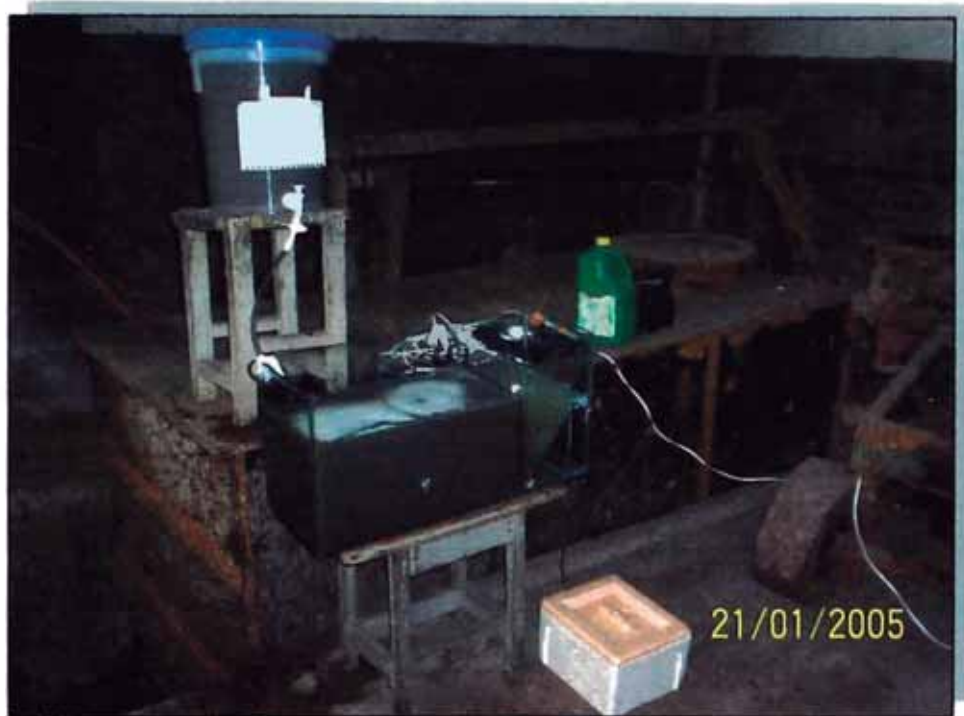
Foto N° 5.2.1: Vista de la Planta de Lodos Activados
