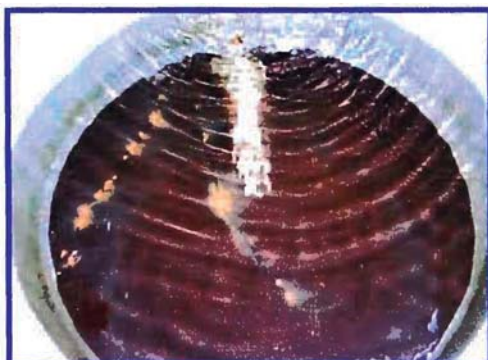
Estado fisico interior del tanque elevado Se observa gran cantidad de sedimentos H-53
