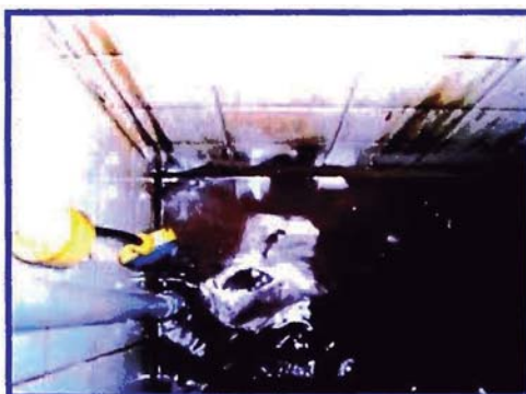
Estado fisico interior de la cisterna. Se observa gran cantidad de sedimentos. C-59
