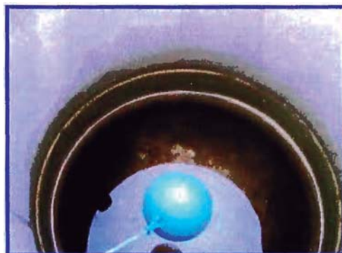
Estado fisico interior del tanque elevado. Se observa gran cantidad de sedimentos F-35
