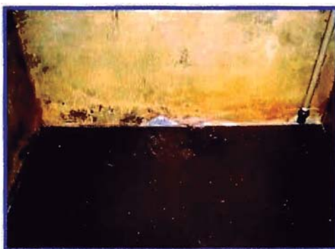
Estado fisico interior de la cisterna. Se observa gran cantidad de sedimentos L-38
