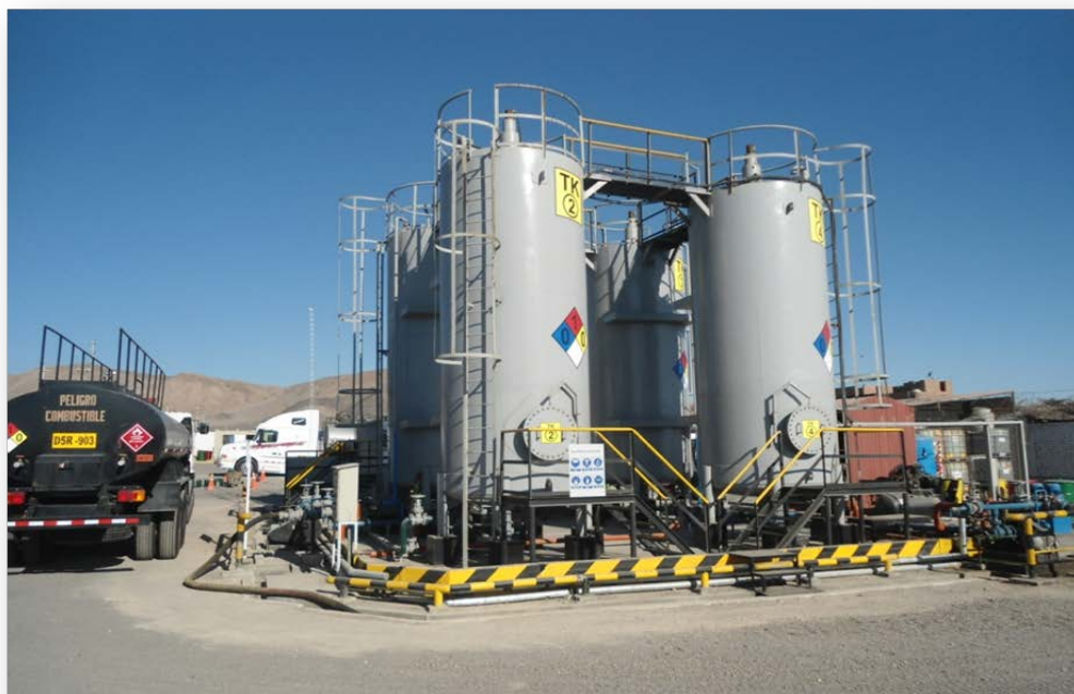
Figura 3: Planta de Emulsión Asfáltica
