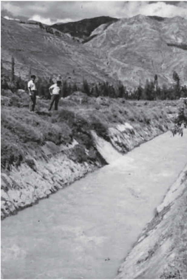
3.-AFORANDO EN LA DESCARGA DEL EMISOR DE DESAGUES AL RIO TARMA.
