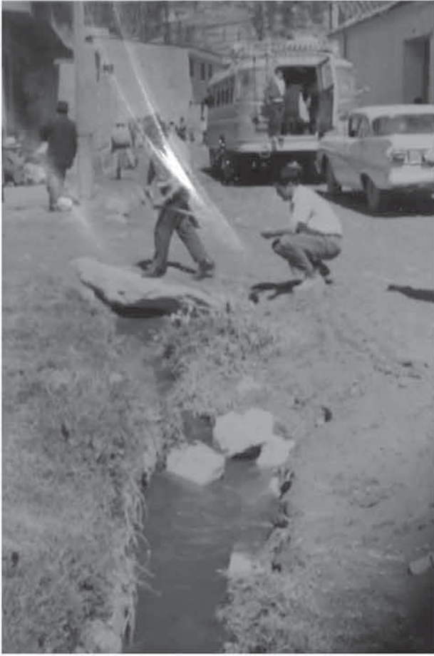
5.- CANAL DE DRENAJE PLUVIAL NOTESE SU ESTADO
