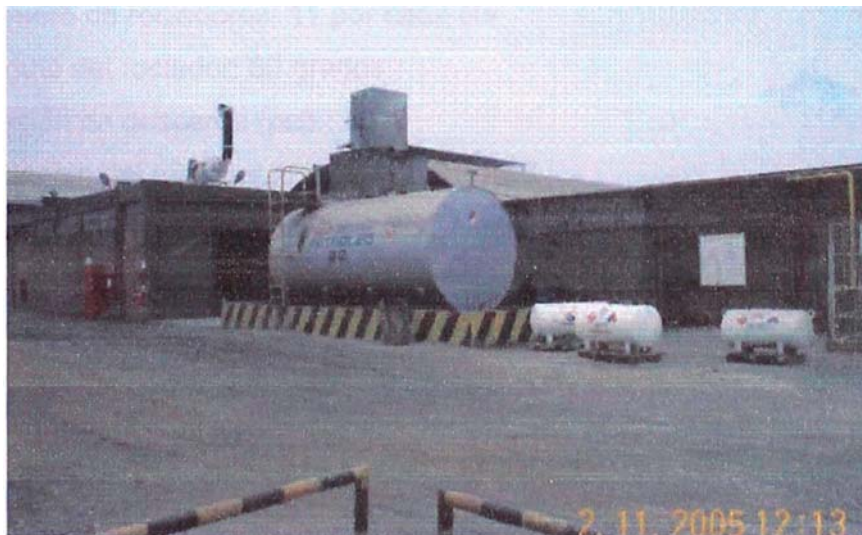
Foto N° 4: Tanque de petróleo que abastece a las Unidades operativas ubicado en el área de la Unidad operativa Oxido de Zinc
