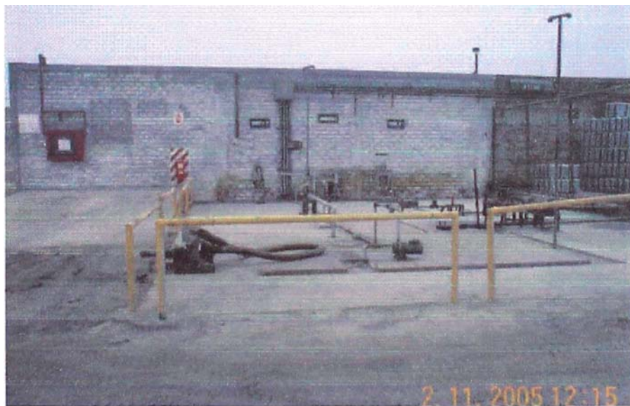
Foto N° 2: Abastecimiento de petróleo para las unidades de transporte de carga
