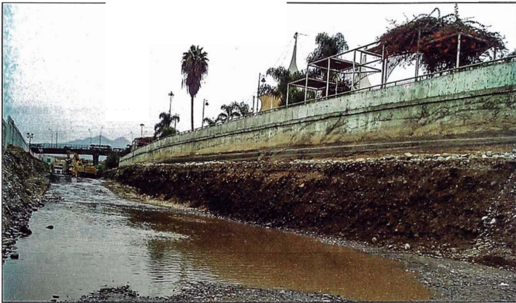
Figura N° 3.01: Excavación del primer nivel, profundidad 2.00 a 2.50 m, según indicaciones de los planos.
