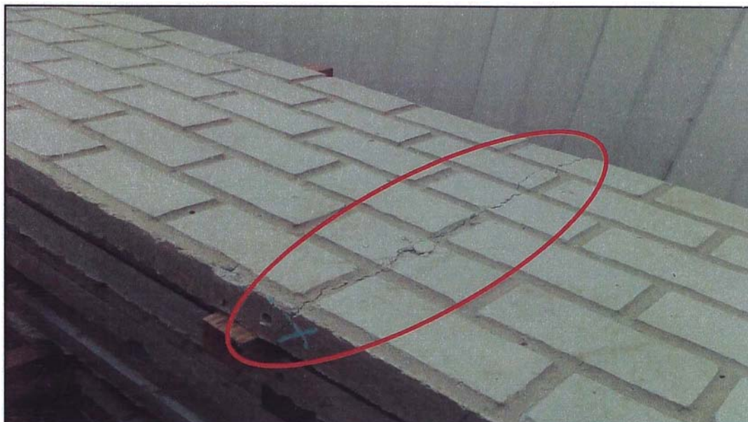
Figura N° 3.4. Presencia de fisuras – GyM S.A.
