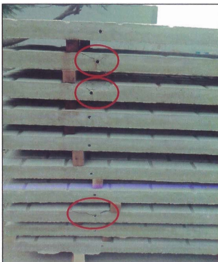
Figura N° 3.3. Presencia de fisuras – GyM S.A.
