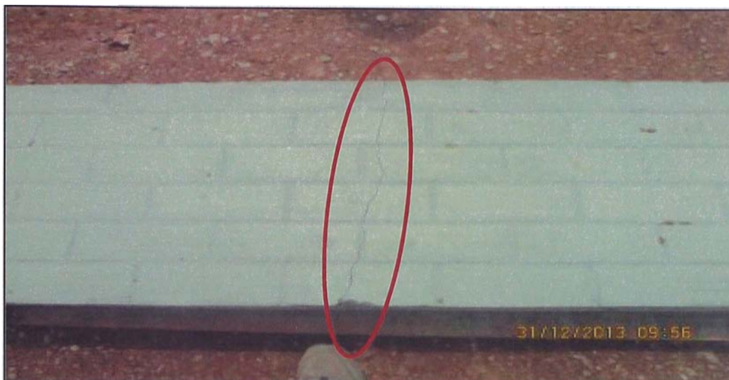
Figura N° 3.2. Presencia de fisuras – ENTREPISOS LIMA S.A.C
