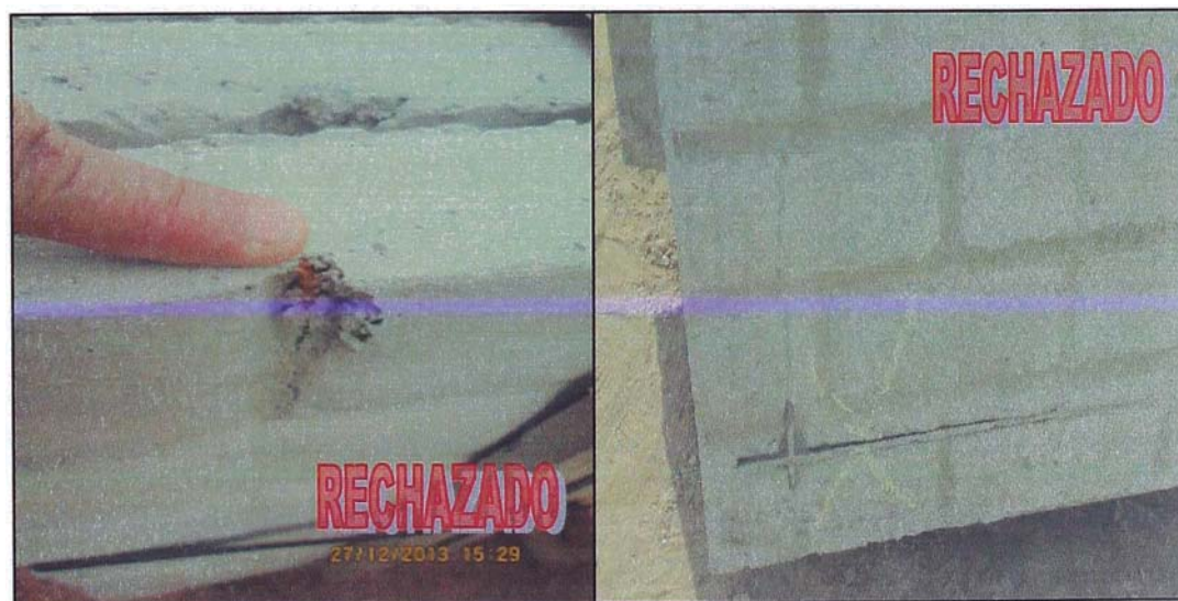
Figura N° 3.10. Línea base de aceptación – Acero expuesto
