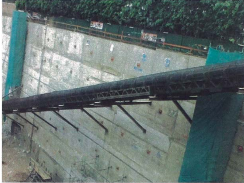
Figura 21 Encapsulamiento de la faja Principal
