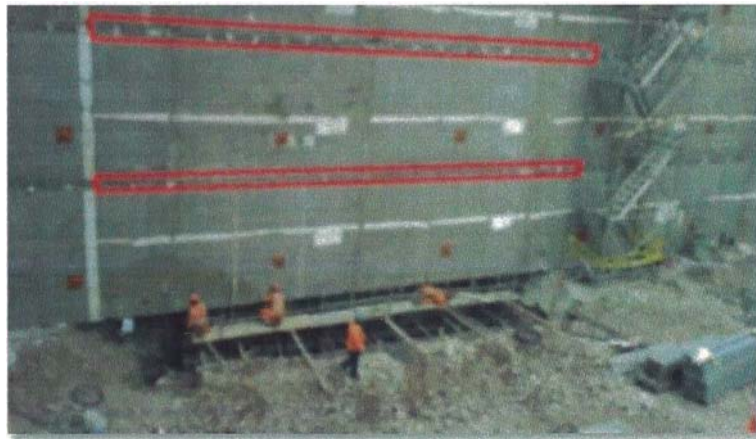
Figura 44 Costura de unión de muros generada por la desincronización de niveles.
