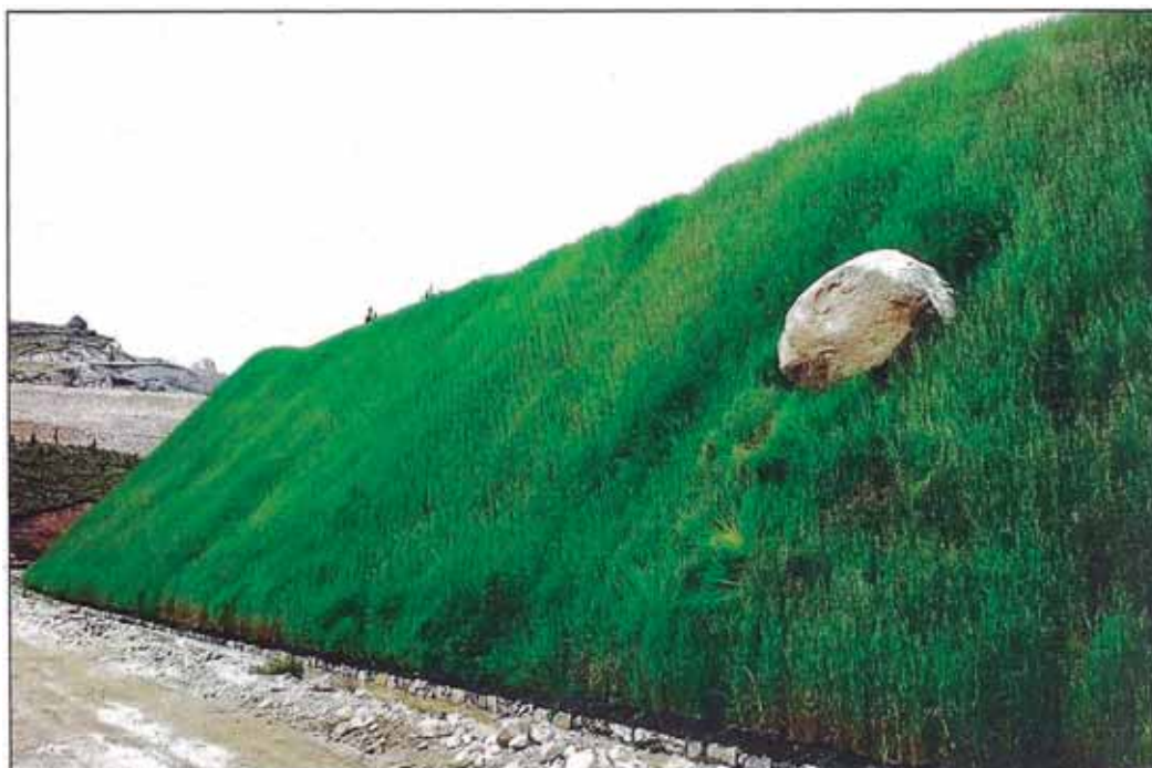
Figura N°3.11 Taludes después de la revegetación con el Sistema Geoweb . Minera Barrick-La Libertad. Fuente, Cortesía de Andex del Norte.
