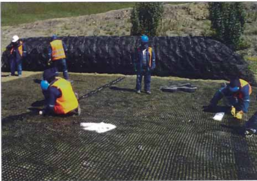
Figura N°4.6 Colocación de la geomalla sobre el talud. Fuente, Cortesía de Andex del Norte.
