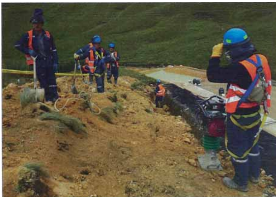
Figura N°4.5 Relleno y compactación en la zanja de coronación. Fuente, Cortesía de Andex del Norte.
