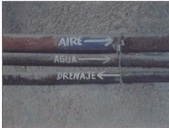
Figura 22: Tuberías para aire, agua y drenaje
