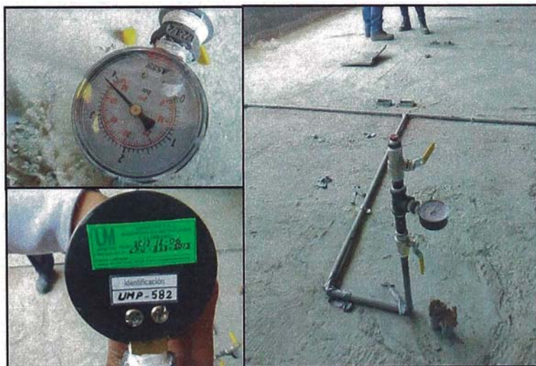
Figura 21: Verificación de Calibración de Equipos en Campo
