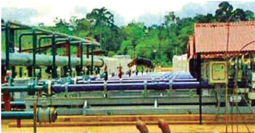
Figura N°07: Bombas de Reinyección de Shiviyacu, bombas de alta presión – 2500 psi (fuente: Osinergmin)
