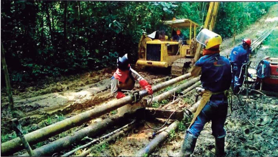
Figura N°24: Alineado de línea diesel de 6" en Capahuari Norte (Fuente: Pluspetrol)
