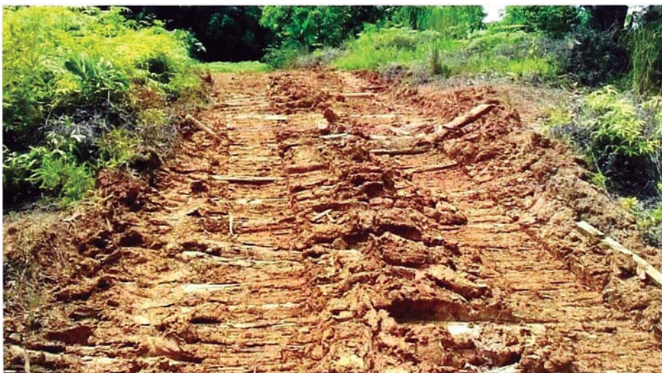
Figura N°19: Limpieza de acceso para ingreso de tractor sideboom D6 en Capahuari Norte (Fuente: Pluspetrol)
