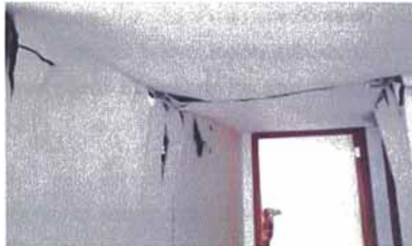
Figura N°4.- Edificación con grietas
