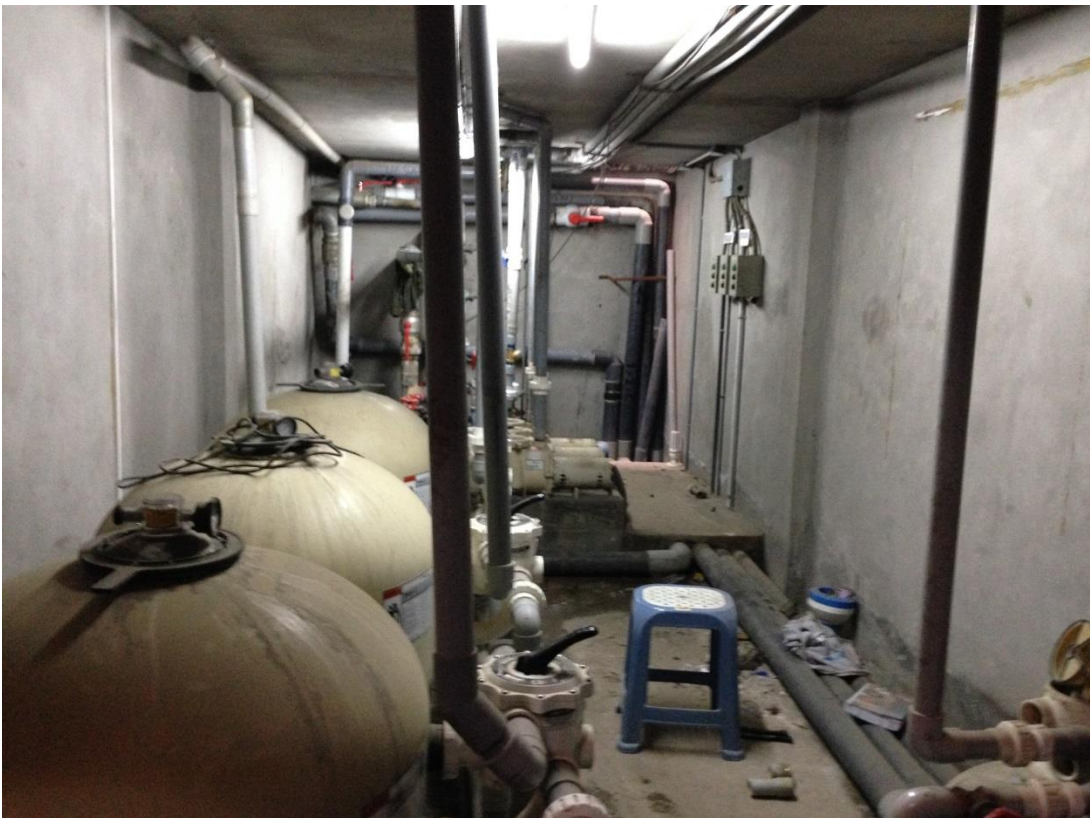
Filtros de Agua, para retener todas las impurezas del agua recirculada por las bombas
