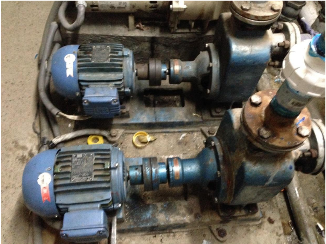
Bombas de Agua para recirculación e igualación de temperatura al valor temperado
