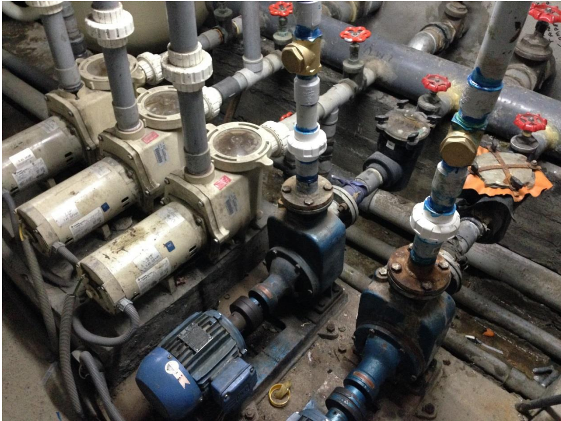
Bombas para inyectar cloro a la piscina
