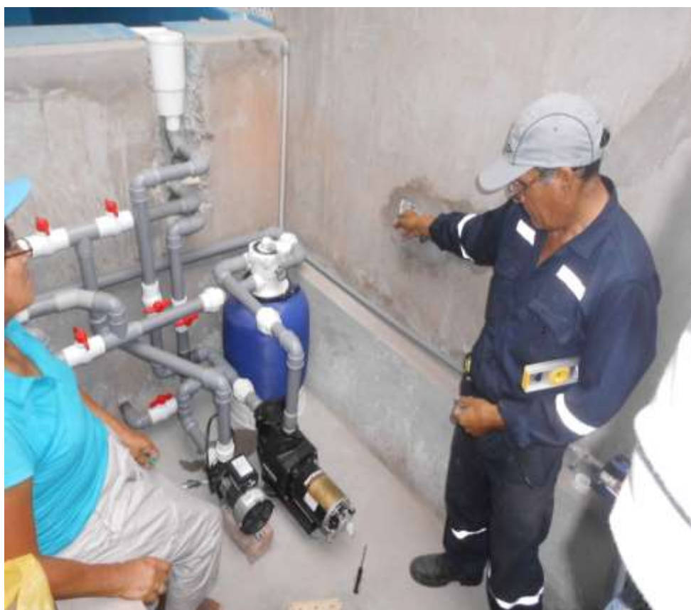
Figura 5.6: Bomba y Filtro de la Piscina del Proyecto
