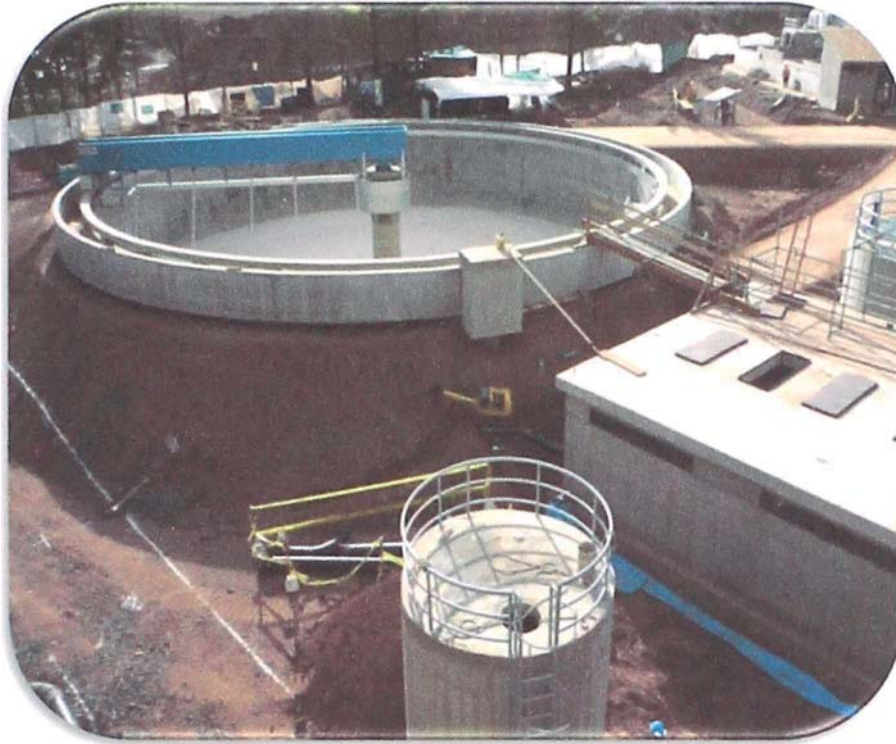
Figura N° 15.- Vista panorámica del Sedimentador Primario N°2 (Fuente: Cosapi S.A)
