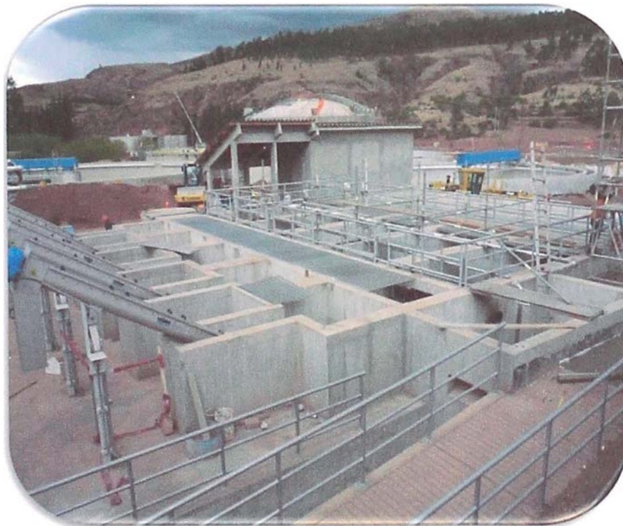
Figura N° 14.- Vista panorámica del Desarenador Aireado
