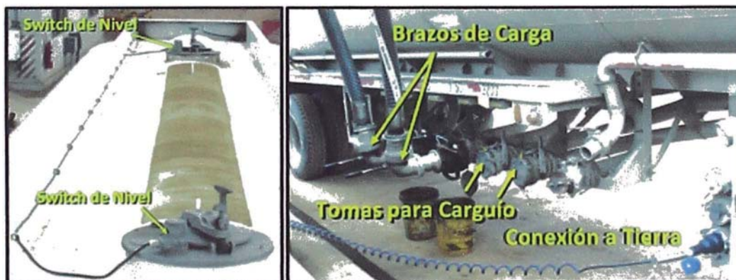
Fig. 6.- SWITCH DE NIVEL, TOMAS PARA CARGUÍO Y CONEXIÓN A TIERRA
