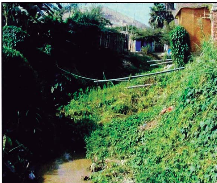
Foto 5.2. Evacuación directa a canales de regadío Fuente: Propia
