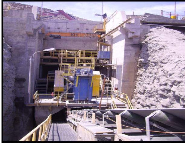
Foto N° 39: Filtro insertable en chancado primario.
