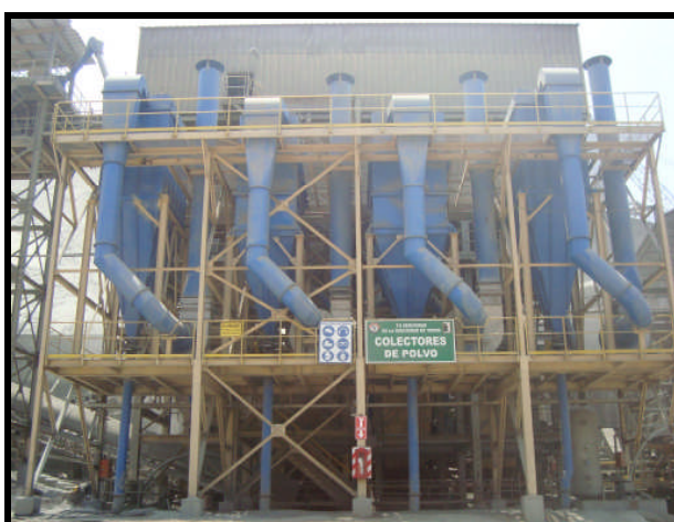
Foto N° 38: Colectores de 25000CFM en zona de Zarandas.
