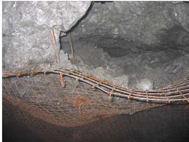
Figura 1.3: Fracturamiento y aflojamiento de la roca
