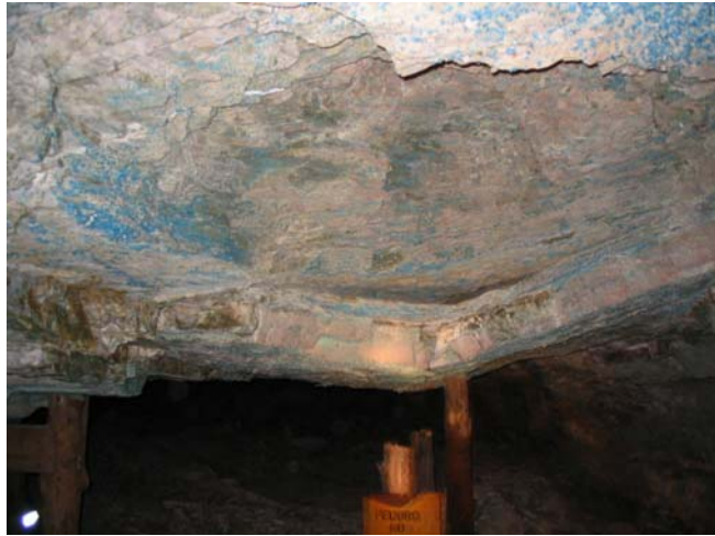
Figura 1.5: Deflexiones excesivas del techo
