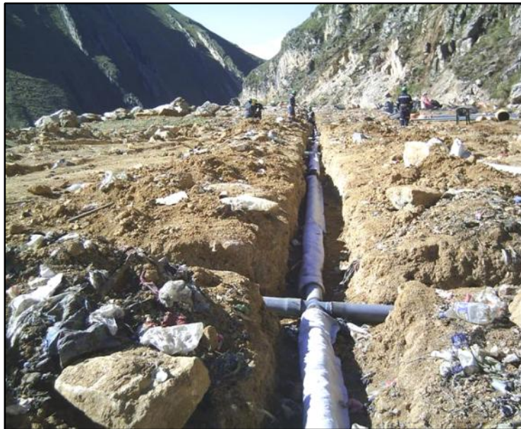
Foto 43: Sistema colector de lixiviados.
