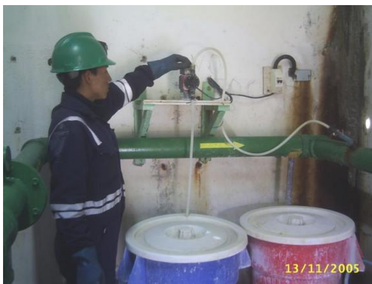
Foto 8: Dosificación de Cloro – Agua Potable.
