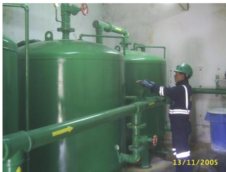
Foto 7: Sistema de filtros en Planta de Agua Potable.
