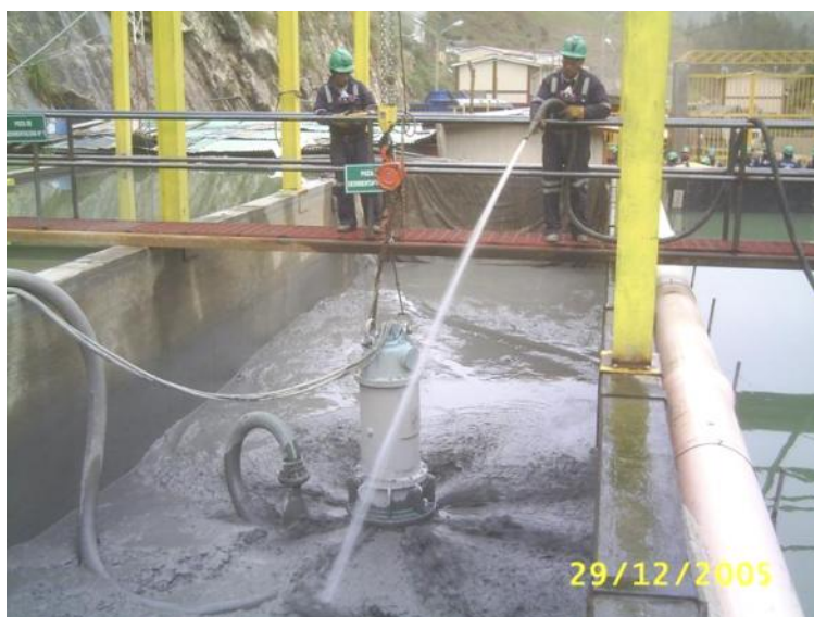
Foto 14: Bombeo de sólidos pozas de sedimentación.
