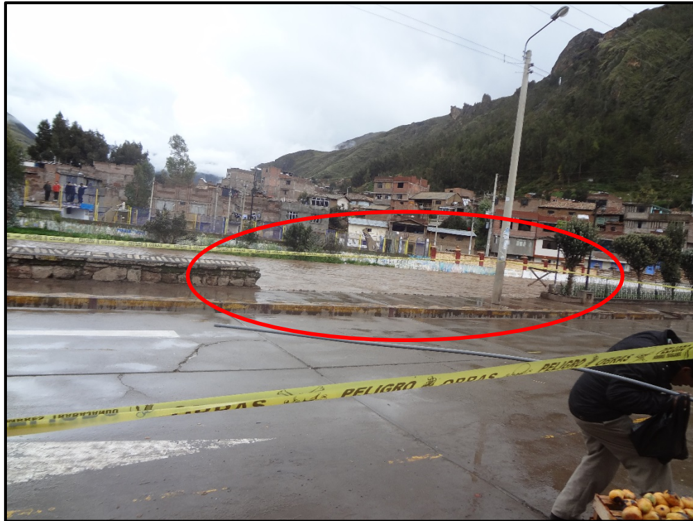
Figura 1.4 : Colapso de Obras de Protección.
