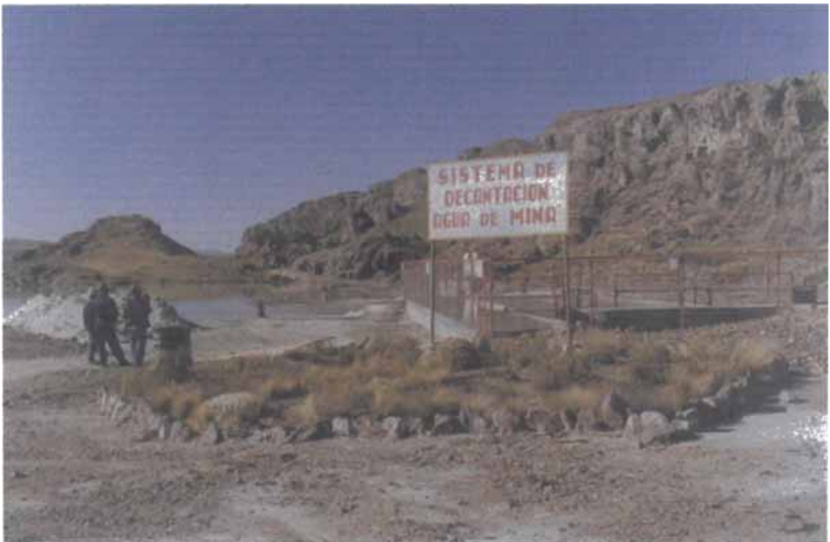
FOTO N° 21 : Vista del Sistema Decantación del agua de mina.
