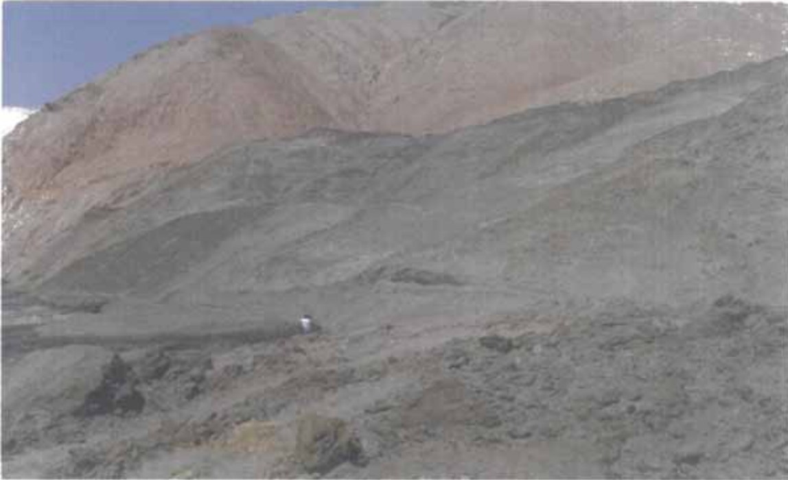
FOTO N° 01: En la imagen se observa el estado en que se encuentra el talud de la relavera de Otapara, Acari luego de los deslizamientos ocasionados por el sismo de noviembre de 1996.
