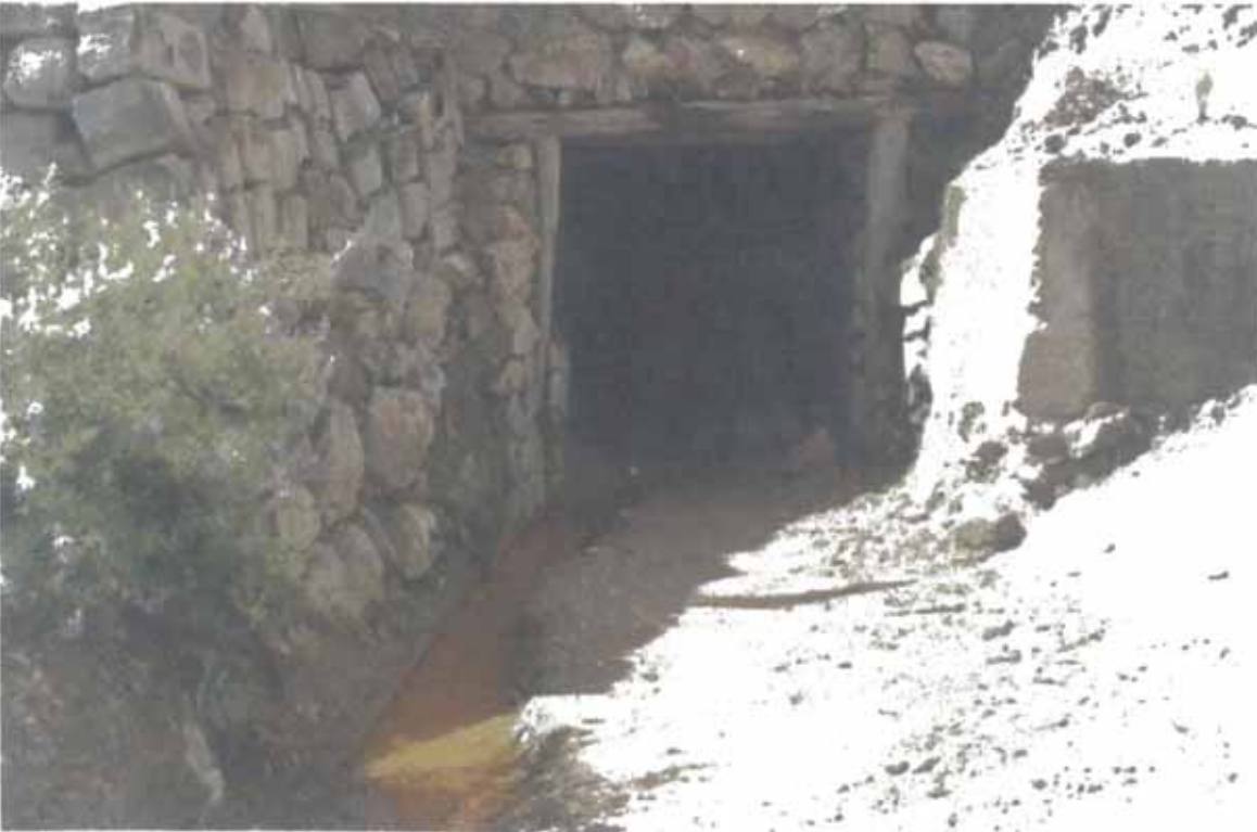
FOTO N° 25 : Drenaje Acido de una mina antigua.
