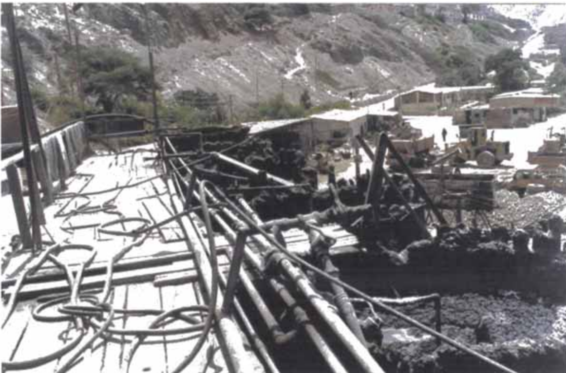
FOTO N° 08 : Planta de cianuración de las Minas de Ocoña.
