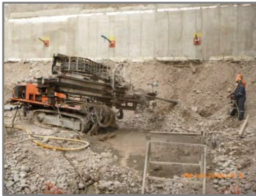
Figura N° 60: Perforación de anclaje, se verificó la ubicación de los puntos de anclajes con topografía.
