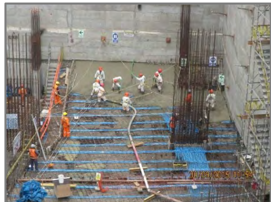
Figura N° 97: Vaciado de concreto de losas postensadas masivo en el sector 01 a nivel de sótanos.
