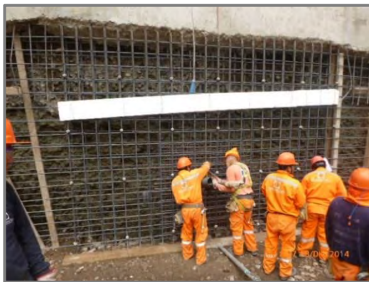
Figura N° 62: Colocación de acero en muro anclado, se inspeccionó en campo la correcta colocación de los aceros según las especificaciones.
