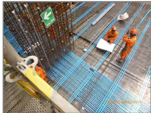
Figura N° 91: Verificación de la cantidad de cables, alturas y ubicaciones.
