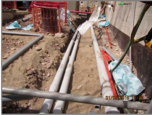
Figura N° 104: Red principal de desagüe, en dirección a la cámara de bombeo en sótanos.
