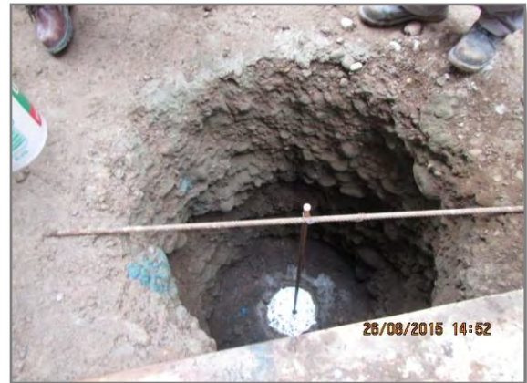
Pozo a tierra
