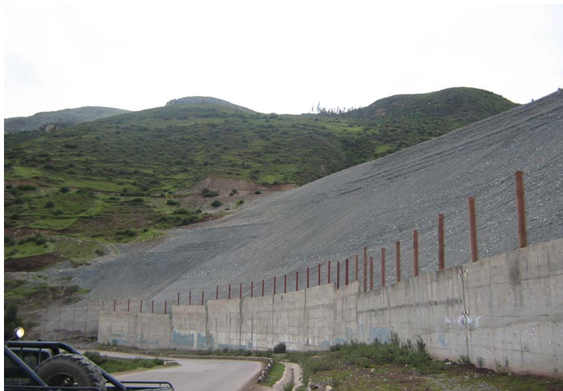
Foto 10: Carretera Central y muro de contención del depósito de relaves Tielacayán
