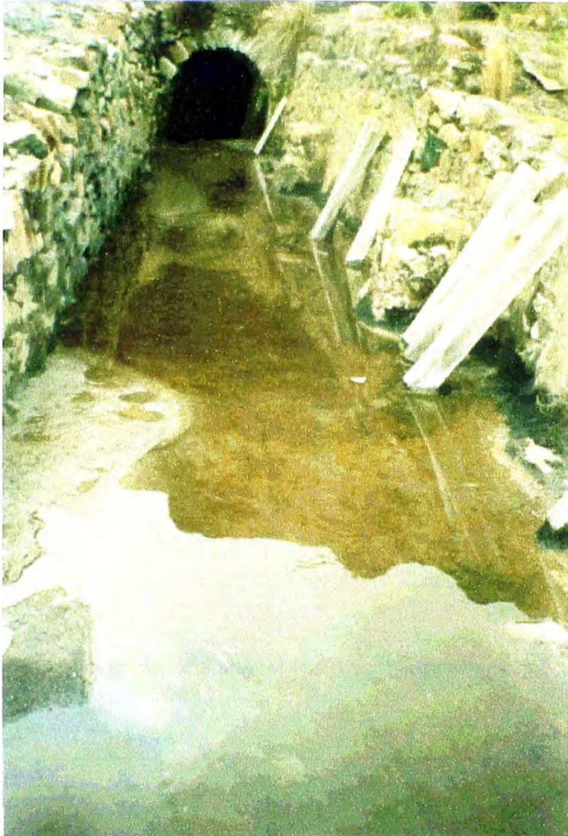
BOCAMINA PRINCIPAL PRECARIAMENTE ESTABILIZADA Y CON DRENAJE ÁCIDO.
