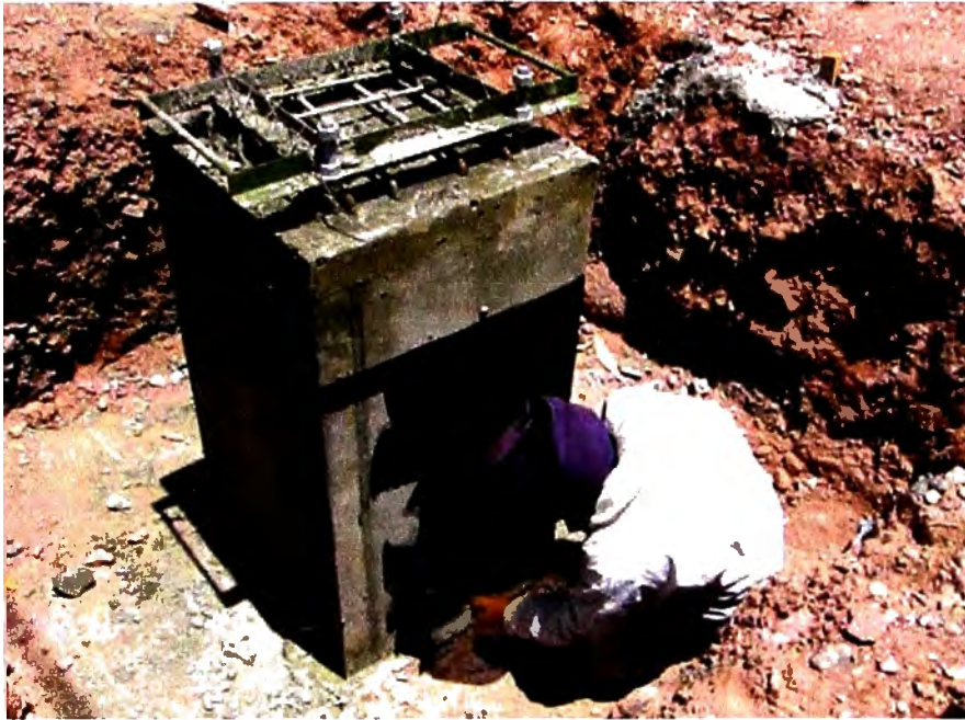
Figura N° 7.13: Fotografía, aplicación de bitumen para proteger el concreto de las sales Fuente: Propia, tomada en etapa de ejecución de obra
