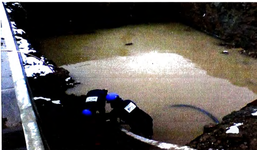
Figura N° 9.7: Fotografía, Retiro de agua de lluvias y/o deshielo con motobombas Fuente: Propia, tomada en etapa de ejecución de obra
