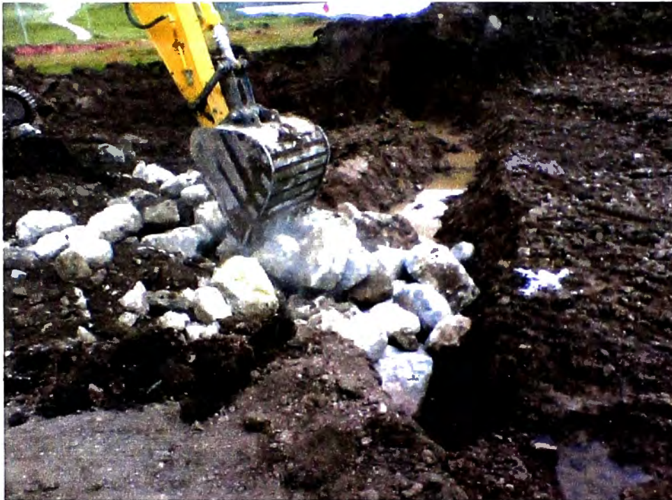
Figura N° 9.3: Fotografía, Colocación de bolonería para estabilizar zona en plataforma N° 03 Fuente: Propia, tomada en etapa de ejecución de obra
