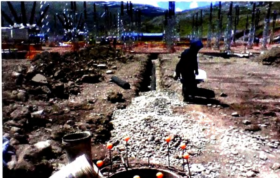
Figura N° 7.19: Fotografía, Colocación de piedra de filtro en drenaje de Plataforma N° 03 Fuente: Propia, tomada en etapa de ejecución de obra
