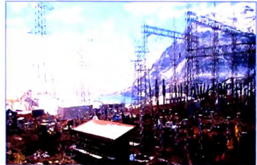
Vista de la S.E. Pomacocha
