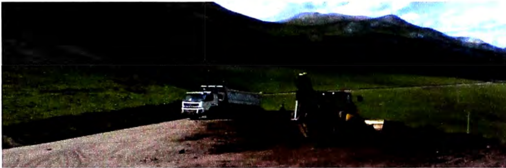
Figura N° 7.15: Fotografía, eliminación del material de las excavaciones en botaderos autorizados Fuente: Propia, tomada en etapa de ejecución de obra.
