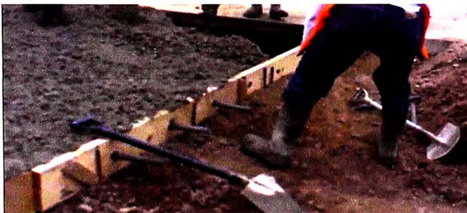
Figura N° 7.4: Fotografía Instalación de dowells en pavimentos Fuente: Propia, tomada en etapa de ejecución de obra
