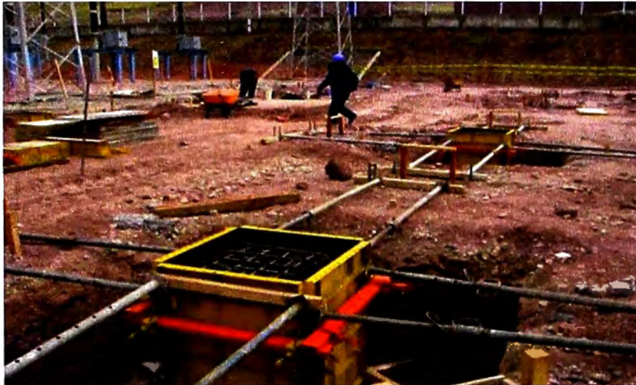
Figura N° 7.11: Fotografía, encofrado de pedestales de base Fuente: Propia, tomada en etapa de ejecución de obra
