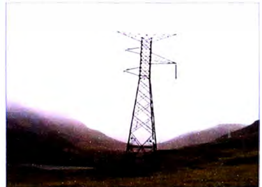
Torre de la LT 220 kV Pachachaca – Pomacocha (Ampliación de capacidad de 152 MVA a 250 MVA)
