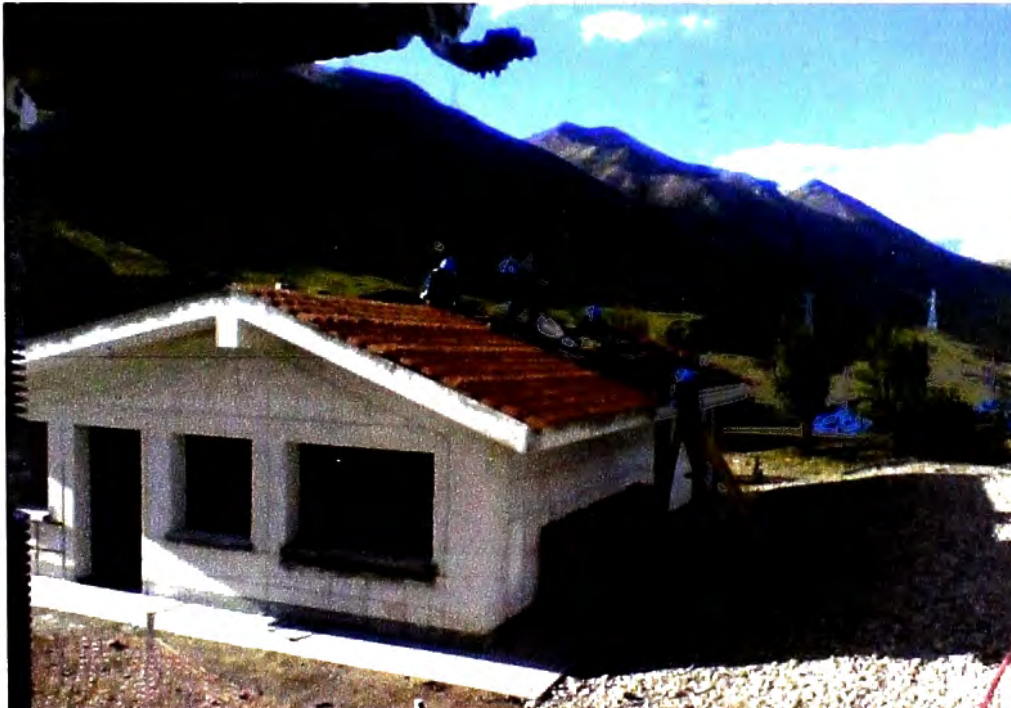
Figura N° 7.27: Fotografía, Instalación de Cobertura de teja andina en techo de Sala de Control Fuente: Propia, tomada en etapa de ejecución de obra.
