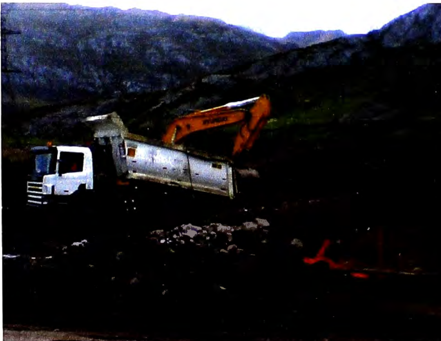
Figura N° 9.2: Fotografía, Estabilización de zona en plataforma N° 3. Fuente: Propia, tomada en etapa de ejecución de obra
