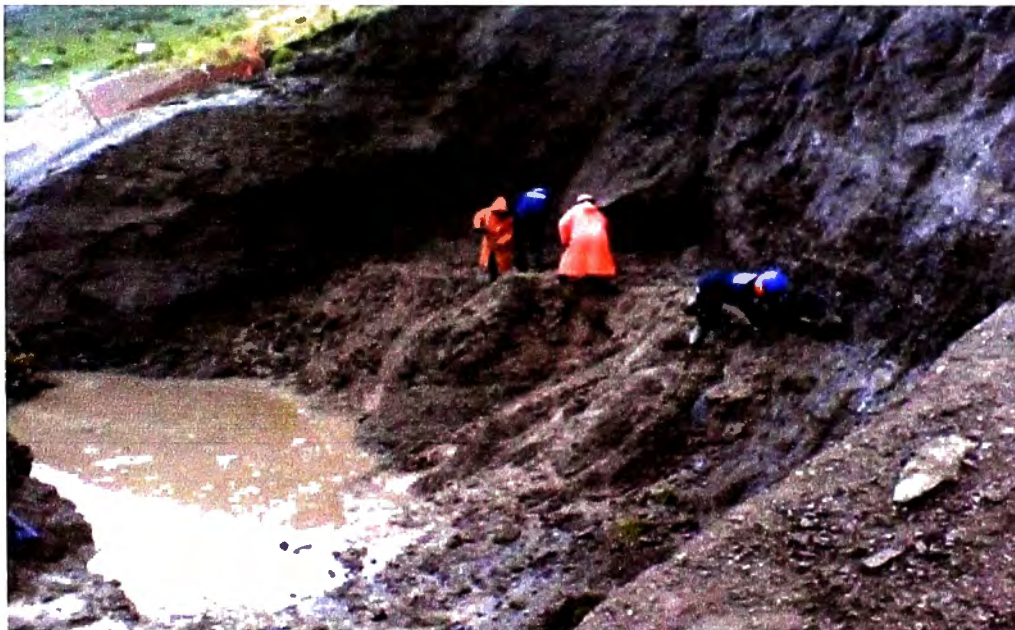
Figura N° 9.5: Fotografía, limpieza de zona de derrumbe para la construcción de base de pórtico Fuente: Propia, tomada en etapa de ejecución de obra
