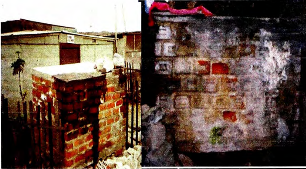
Tanque de almacenamiento de agua fuera de la vivienda.
