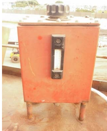
Figura 6.25 Tanque auxiliar ubicado en el techo del puente de navegación.
