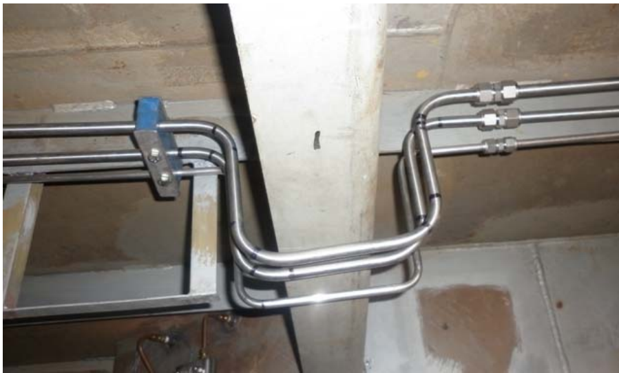
Figura 6.29 Muestra de conexiones de tubing en el sistema hidráulico.
