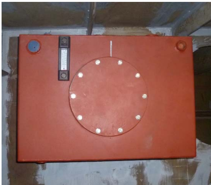
Figura 6.14 Tanque hidráulico ubicado en el lazareto del remolcador.
