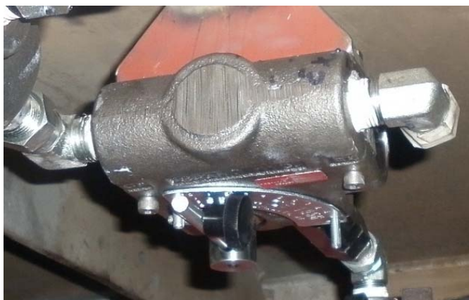
Figura 6.17 Válvula de control de flujo conectado en la línea de presión.
