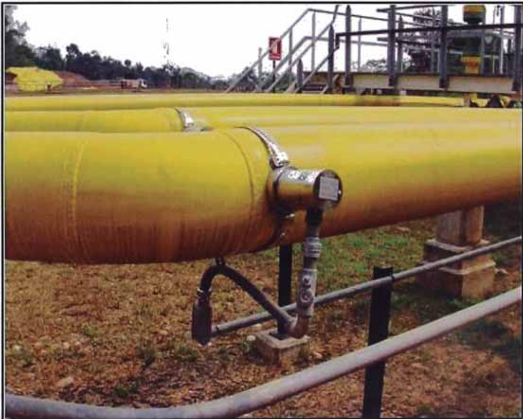
Gráfico N°34: Medidor de partículas instalado en tubería de gas de pozos Cluster Pagoreni A
