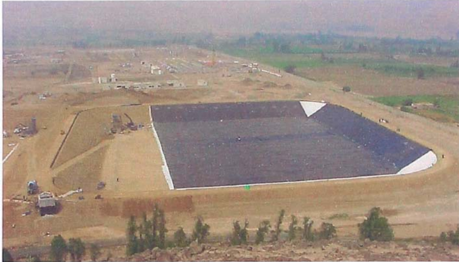
Fig. 08 Planta de tratamiento de agua potable
