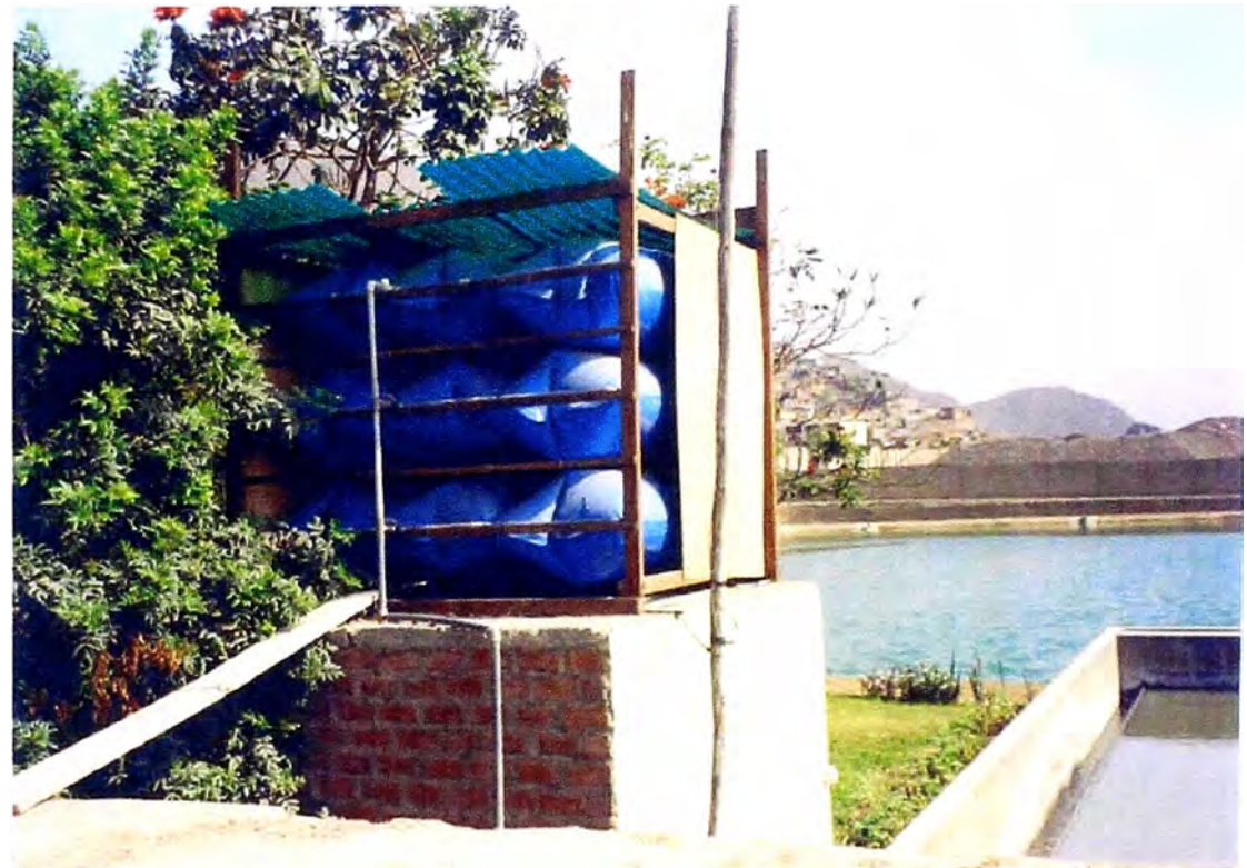
Foto 10. Bolsas de almacenamiento de biogás.
