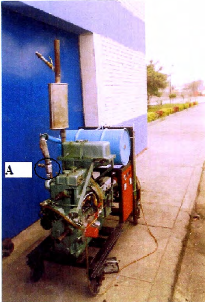
Foto 5. Motor Petrolero Lister con mezclador de aire y biogás (detalle A).
