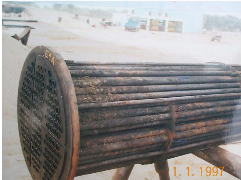
Figura 25: Intercambiador de calor con sales de amina neutralizante
