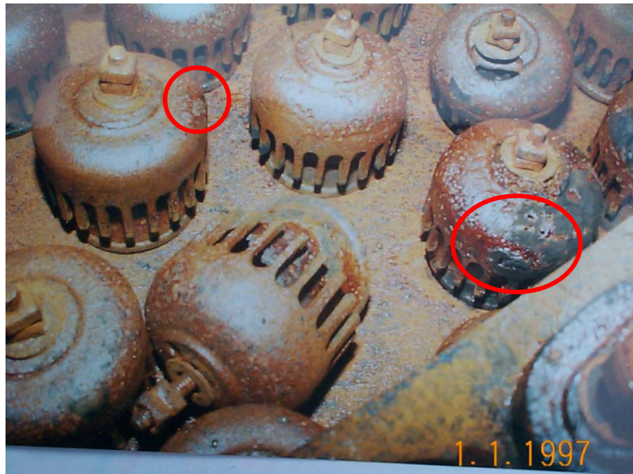
Figura 3: Interior de la columna. Casquetes de burbujeo con picaduras.
