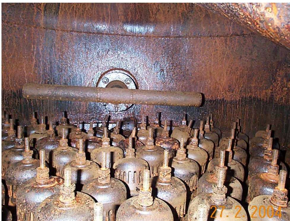
Figura 20: Corrosión encontrada en el plato superior de la columna de destilación
