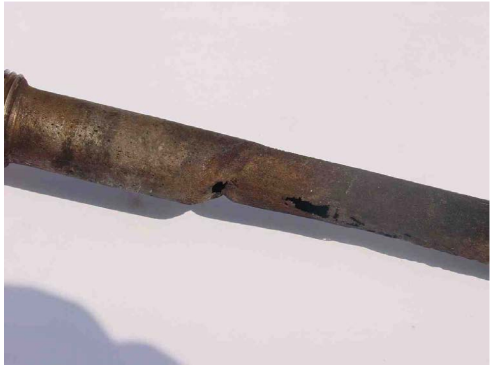
Figura 5: Erosión sobre un termo pozo en la Unidad de Destilación al vacío.
