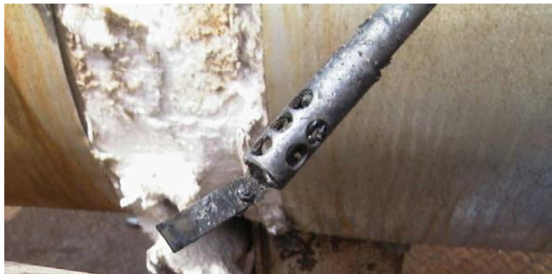
Figura 34: Cupón de corrosión instalado en el sistema de tope de una unidad de destilación primaria de base seca, con agua de lavado.
