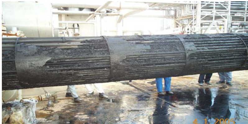
Figura 26: Intercambiador de calor con sales de amina neutralizante
