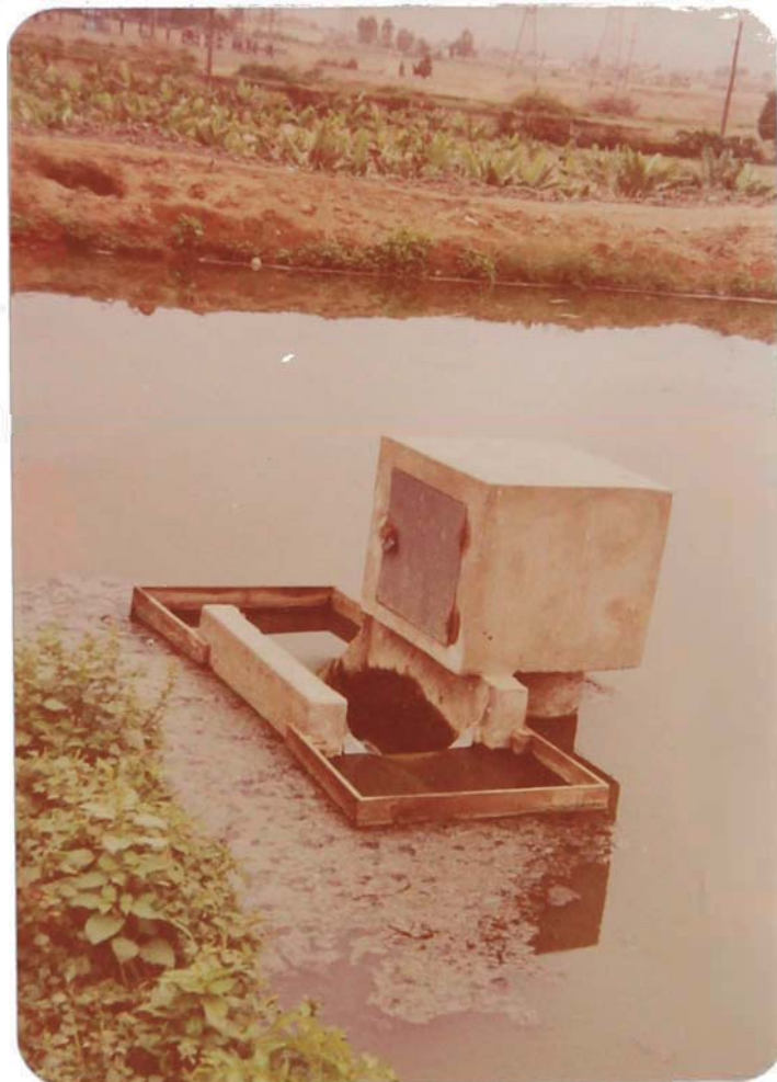
Fig. No. 17' Vertedero Triangular Doble 90^{\circ} y Caseta para muestreo en el efluente de la laguna P1.
