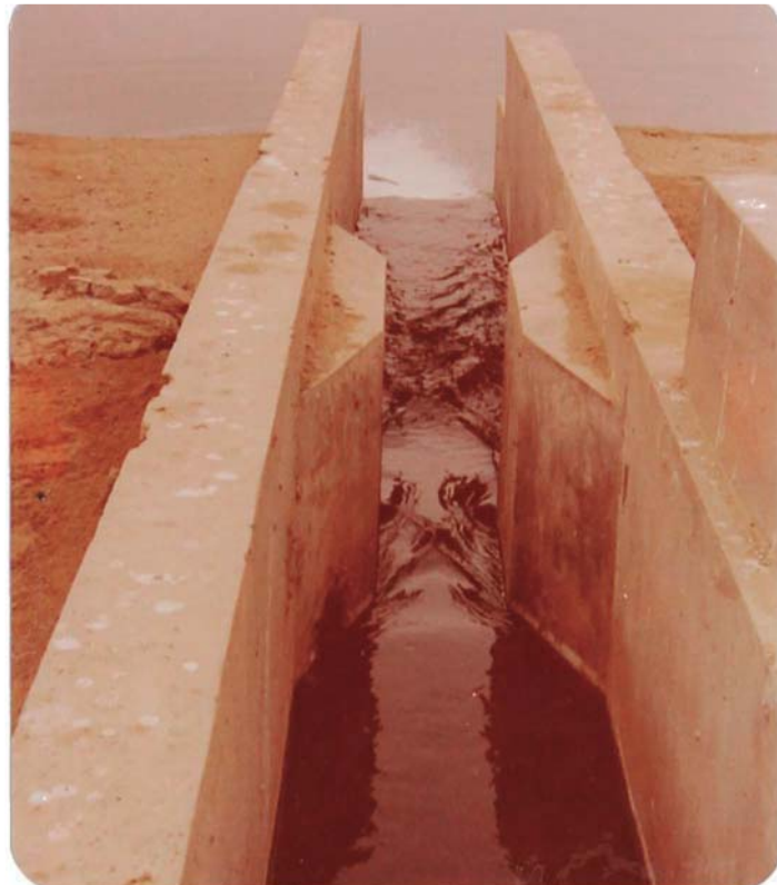
Fig. No. 19' -b Canal del Medidor Palmer-Bowls que interconecta a la laguna T1.
