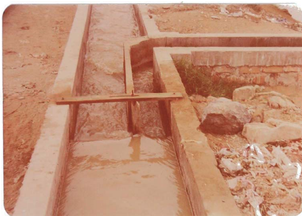
Fig. No. 6 REPARTIDOR DE FLUJO USADO EN LAGUNA DE SAN JUAN.
