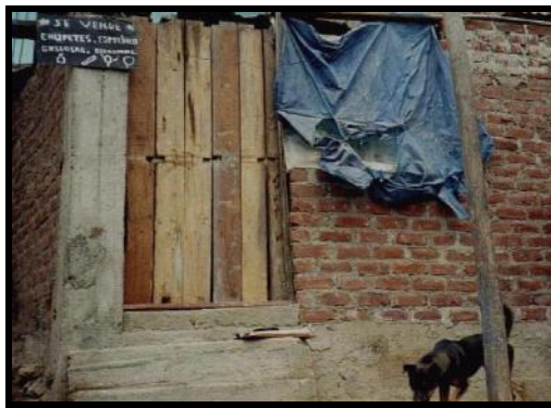
Foto: 15 y16 No hay control sobre las juntas de albañilería. Véase el sobrecimiento desalineado y la mala calidad del ladrillo
