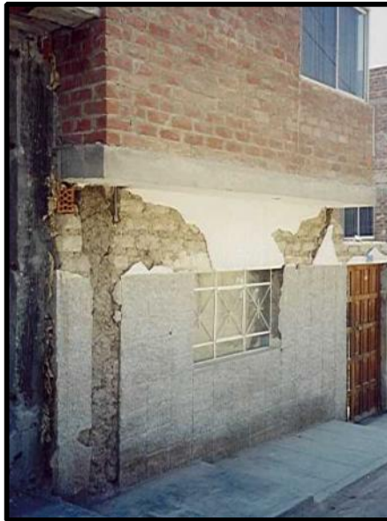
Foto: 14 La falta de asesoría en la autoconstrucción trae como consecuencia graves errores como el alternar materiales de tabiquería sin ningún criterio técnico
