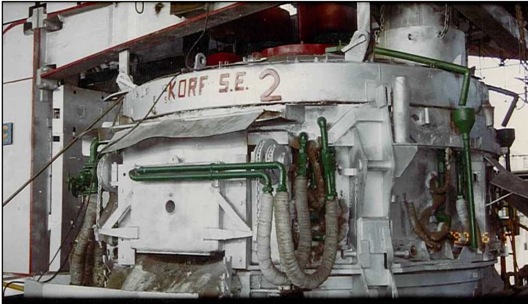
Fig.5.- Horno Eléctrico de Arco, 45t de capacidad de carga, transformador de 45MVA de potencia. Producción 440 mil toneladas de acero/año.
