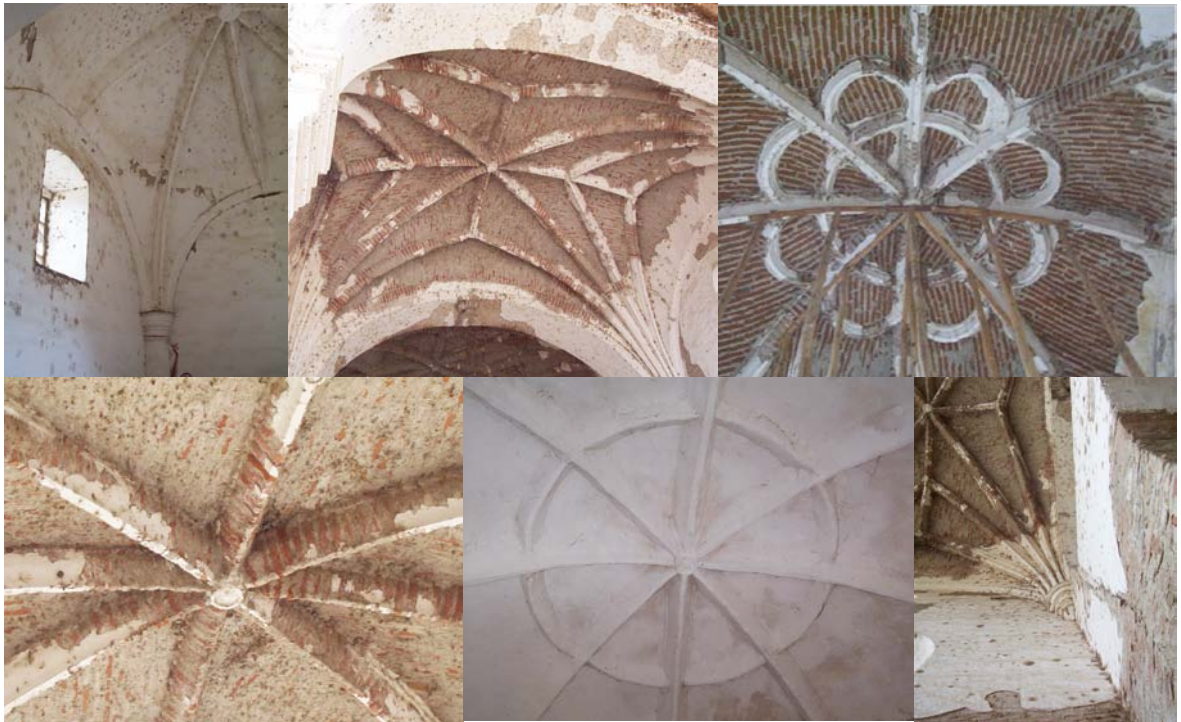
Arriba vistas de las bóvedas con nervaduras antes de ser restauradas. Abajo fotos de las bóvedas después de ser restauradas. Fotos de los autores
