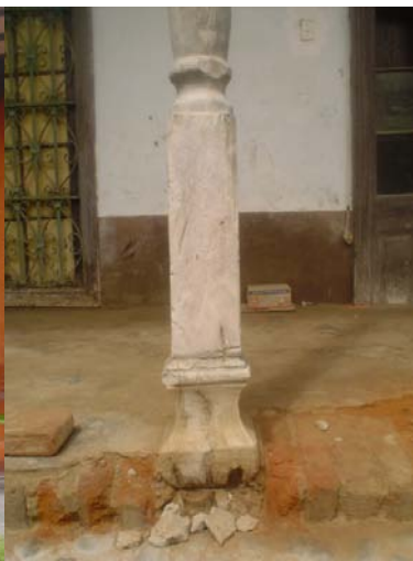
Detalle de los pies derechos de madera de las galerías del primer y segundo nivel, las mismas que se apoyan empotradas en el piso.
