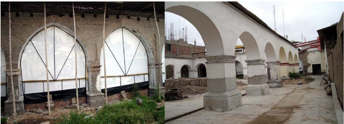
Componentes constructivos de los arcos de los claustros: de adobe íntegramente. Arcos estructurados por dovelas, apoyados en pilares, que recibieron la estructura de cuarterones de madera de las cubiertas de los corredores o galerías.
