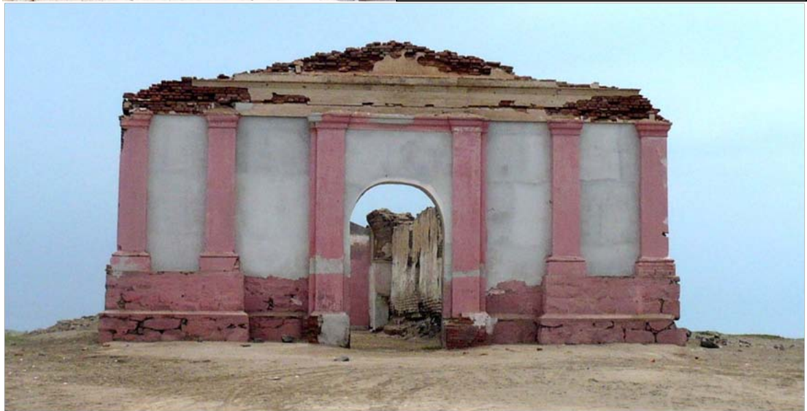
Restos de la fachada de la Iglesia del Milagro de Eten. Observar la fábrica que está compuesta por bases (cimiento y sobrecimiento) de piedra grande y pilares, muro y ornamentación de ladrillo.
