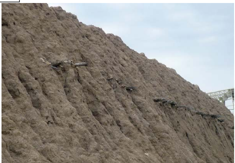
Sector lateral de Huaca Larga, Obsérvese la hilera de troncos sobresaliendo del talud. Foto tomada por los autores
