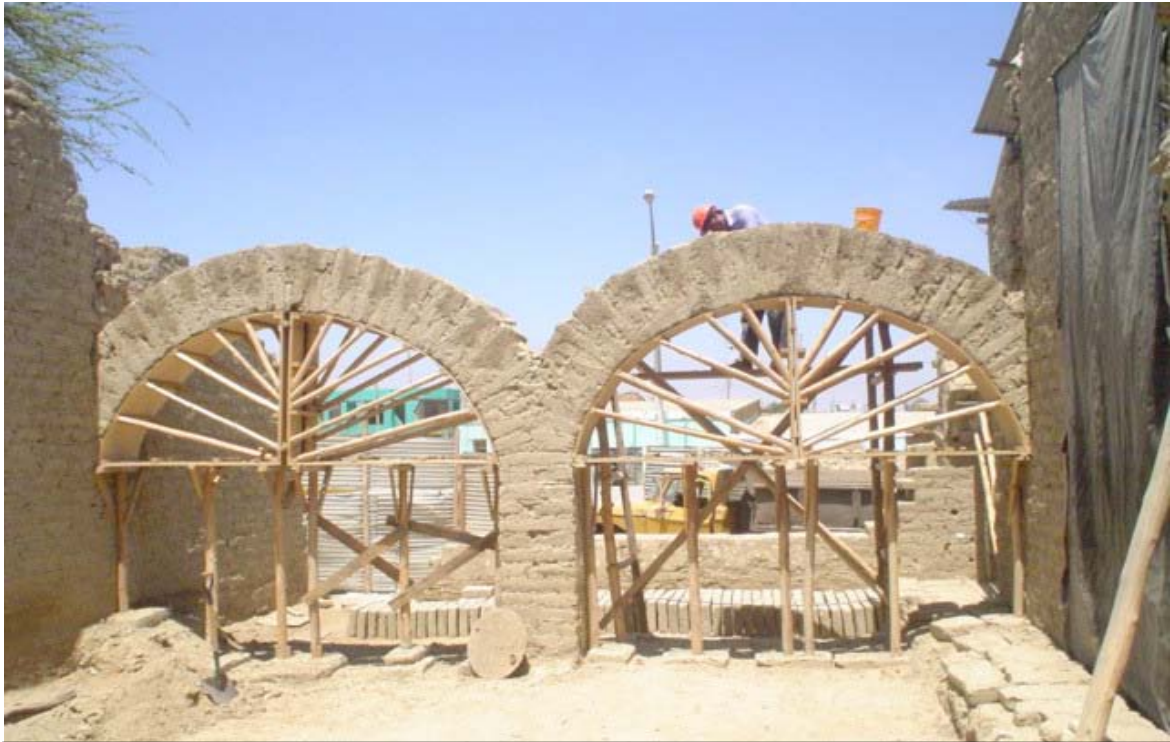
Restauración y reintegración de los arcos semi-elípticos de adobe ubicados tras el altar de la capilla Interior de la Capilla Doctrinal de Mórrope. Fuente: World Monuments Fund. 2007. Annual Report.
