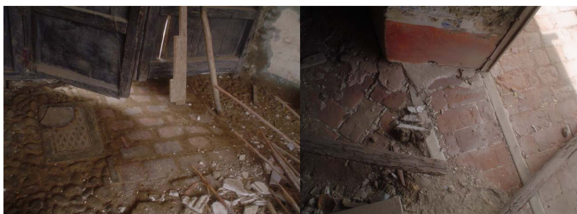
Acabados de pisos: Izq. En el zaguán se aprecia canto rodado y ladrillo pastelero rectangular. Der. En el segundo piso, ladrillo pastelero rectangular colocado en espinapez con listones de madera separadores de las tramas.
