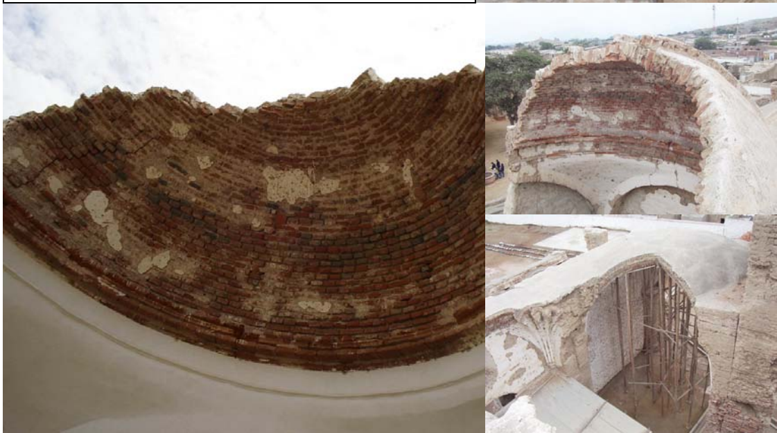
Vistas de Cúpula de media naranja entre Iglesia y Claustro semiderruida mostrando claramente el tipo de albañilería empleado.
