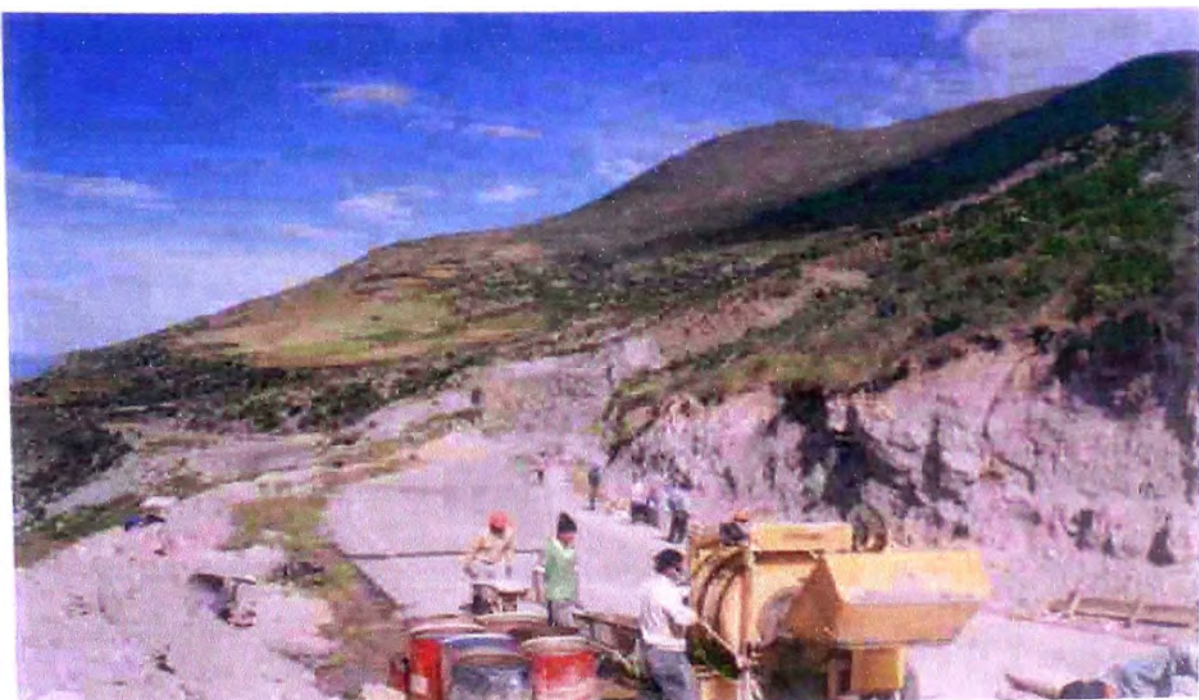
Fotografía VII-4.- La preparación del concreto se realiza con una mezcladora con tolva de 7 p 3 de capacidad.
