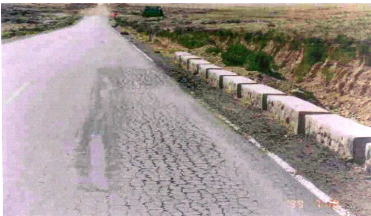
Fotografía II-3.- Fisura generalizada en forma de malla cerrada, formando la llamada “Piel de Cocodrilo” . Falla Tipo 8:
