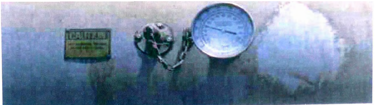
Fotografía VIII-8.- Manómetro ubicado en el lado izquierdo del tanque, indica la temperatura del líquido asfáltico.
