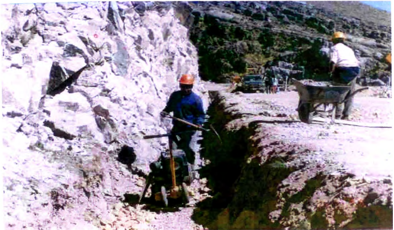
Fotografía VII-13.- Luego de colocar el tubo perforado, se coloca el material filtrante por capas, efectuando la compactación debida.
