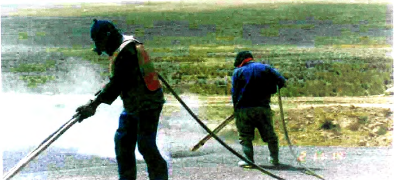
Fotografía VIII-18.- Se elimina el agregado excedente de la primera capa para continuar con la ejecución de la segunda capa, se utiliza una compresora neumática.
