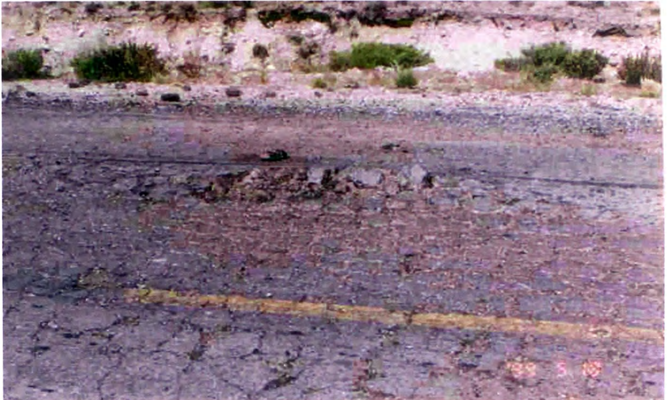
Fotografía II-4.- Fisura totalmente generalizada, con desprendimiento de panes de material: Falla Tipo 10.
