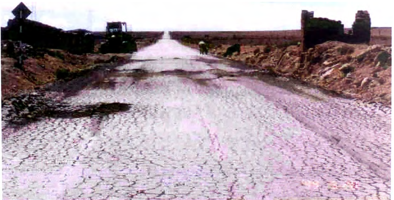
Fotografía II-5.- Obsérvese la falla general del tramo, con presencia de asentamientos superiores a 2"; revelando una capacidad estructural deficiente.
