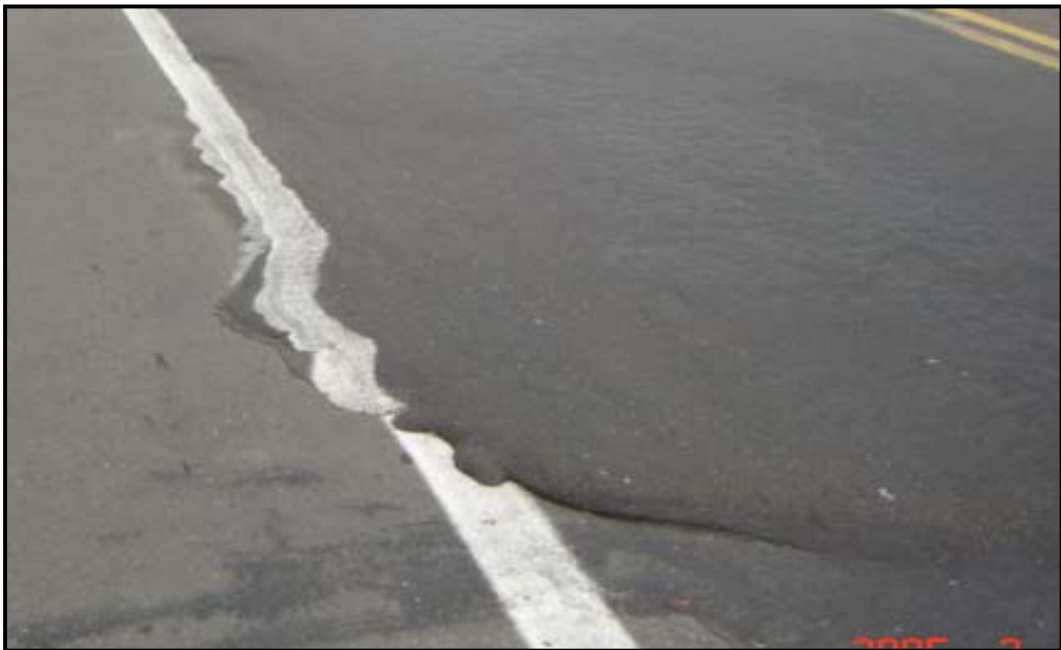
Fotografía 7.2: Falla por abultamiento
