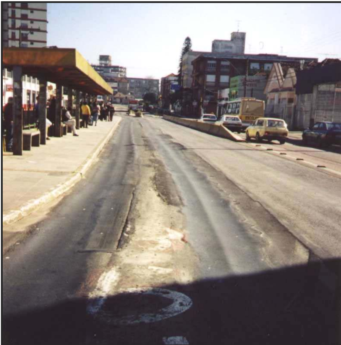
Figura 3.2: Vista Fotográfica del Ahuellamiento
