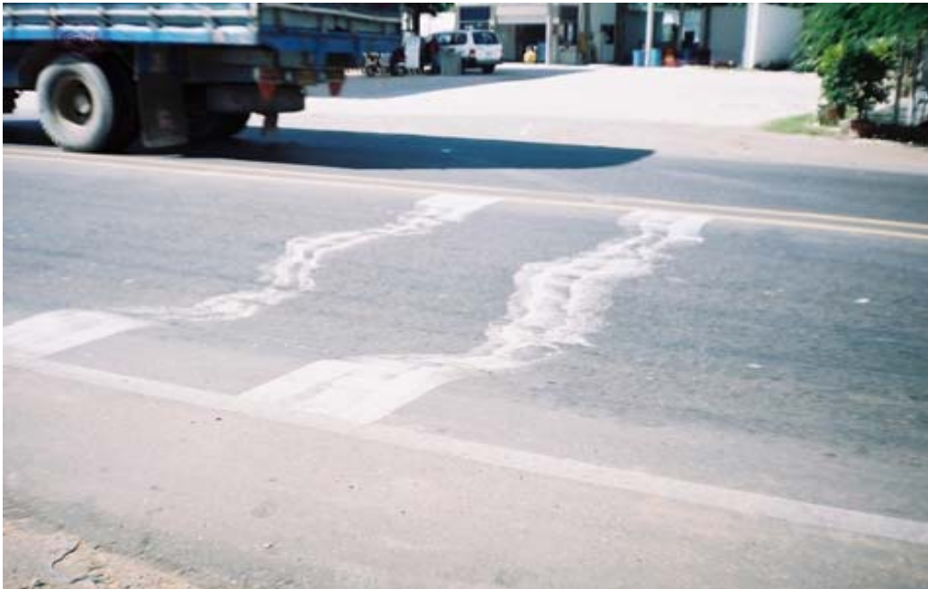
Fotografía 7.4: Falla por ahuellamiento
