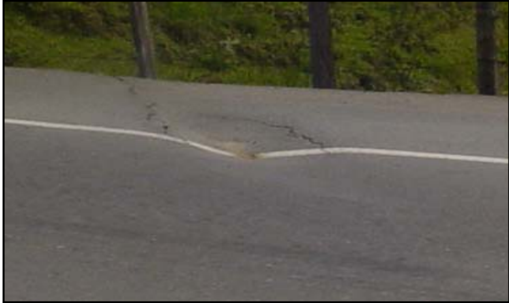
Fotografía 7. 3: Falla por hundimiento
