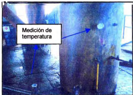
FOTO 7. TERMÓMETROS UBICADOS EN EL TANQUE DE CALENTAMIENTO
