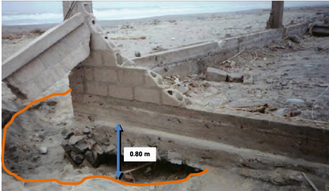
F4.1.4 Socavación en suelo arenoso. Obsérvese la profundidad de cimentación
