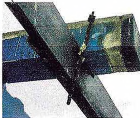
Fig. 9. Atracadero artesanal. El desplazamiento de la viga muestra el impacto de ola a dicha altura.
