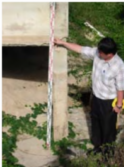
F7.3.4 Profundidad de Erosión. Indonesia (2004). Fuente: Dr. Anat Ruangrassamee
