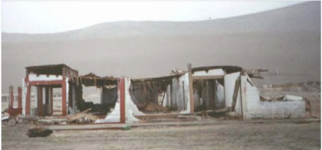
F4.1.2 Vivienda en La Punta, Camaná – Impacto directo en tabiquería
