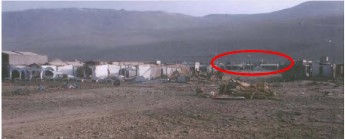
F4.1.6 Muros frontales derribados por el impacto de olas. Sin embargo, viviendas en la parte posterior no presentan mayores daños. Los Cerrillos, Camaná
