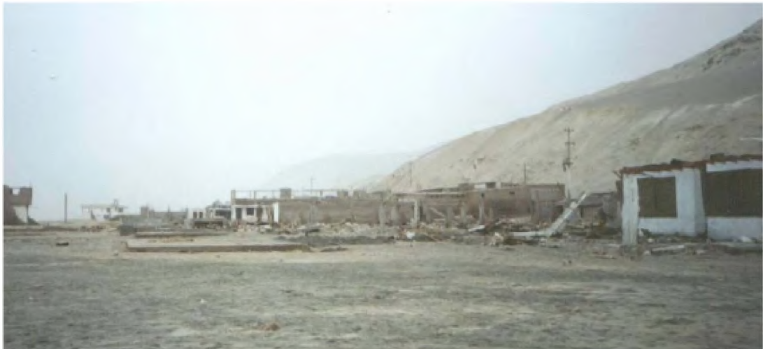
F4.1.3 Vivienda en Los Cerrillos, Camaná – Bloques de cemento, baja resistencia de los materiales
