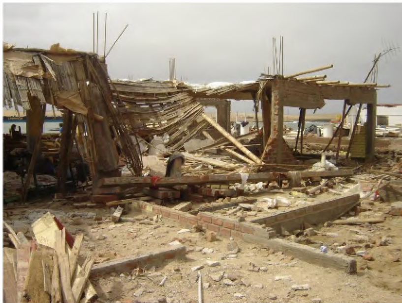
F4.3.6. Restaurante en Lagunillas de albañilería confinada y techo de caña guayaquil. La tabiquería es derribada por la ola y con la pérdida del muro la consecuente caída del techo.
