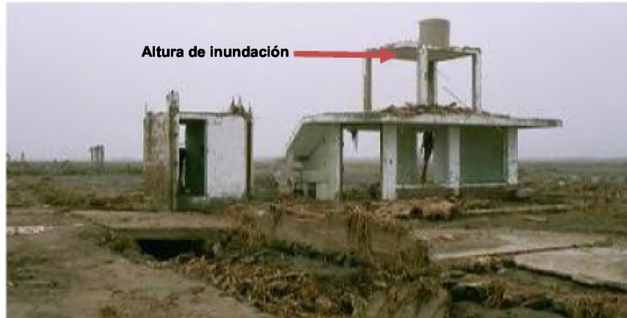
F4.1.12 Vivienda con muros de albañilería arrasados, sin embargo la estructura de concreto armado permanece en pie sin mayores daños estructurales. Playa El Chorro. Camaná
