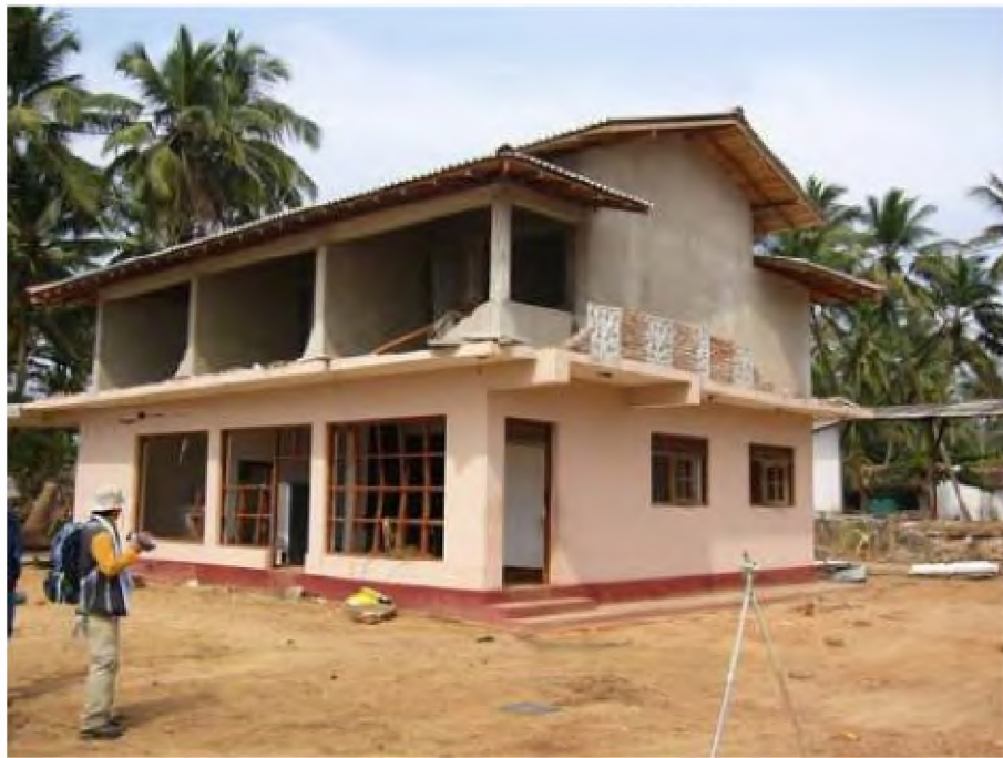
F4.2.21 Estructura de concreto armado ubicada en Paiyagala a 48km al norte de Kahawa con niveles de inundación de 4.2m en tierra. Se aprecia los daños a puertas y ventanas y la resistencia de elementos de concreto.
