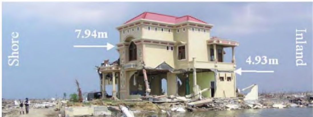
F4.2.20 Vivienda parcialmente dañada localizada a 0.9km de la costa en Banda Aceh. Las alturas son respecto al nivel medio del mar.
