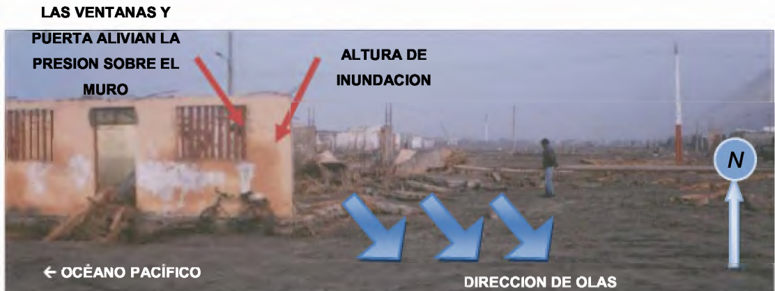
F4.1.7 Viviendas de quincha y muros de bloque de concreto, Los Cerrillos, Camaná. Obsérvese el muro frontal en pie y las marcas del nivel de inundación
