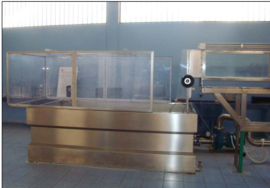
Fotografía 8.- Tanque de Almacenamiento y bomba de impulsión.
