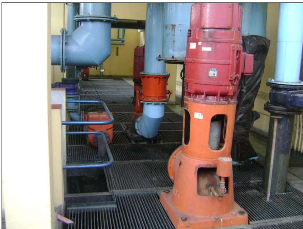
Fotografía 11.- Tanque Cisterna y Bombas (UNI)
