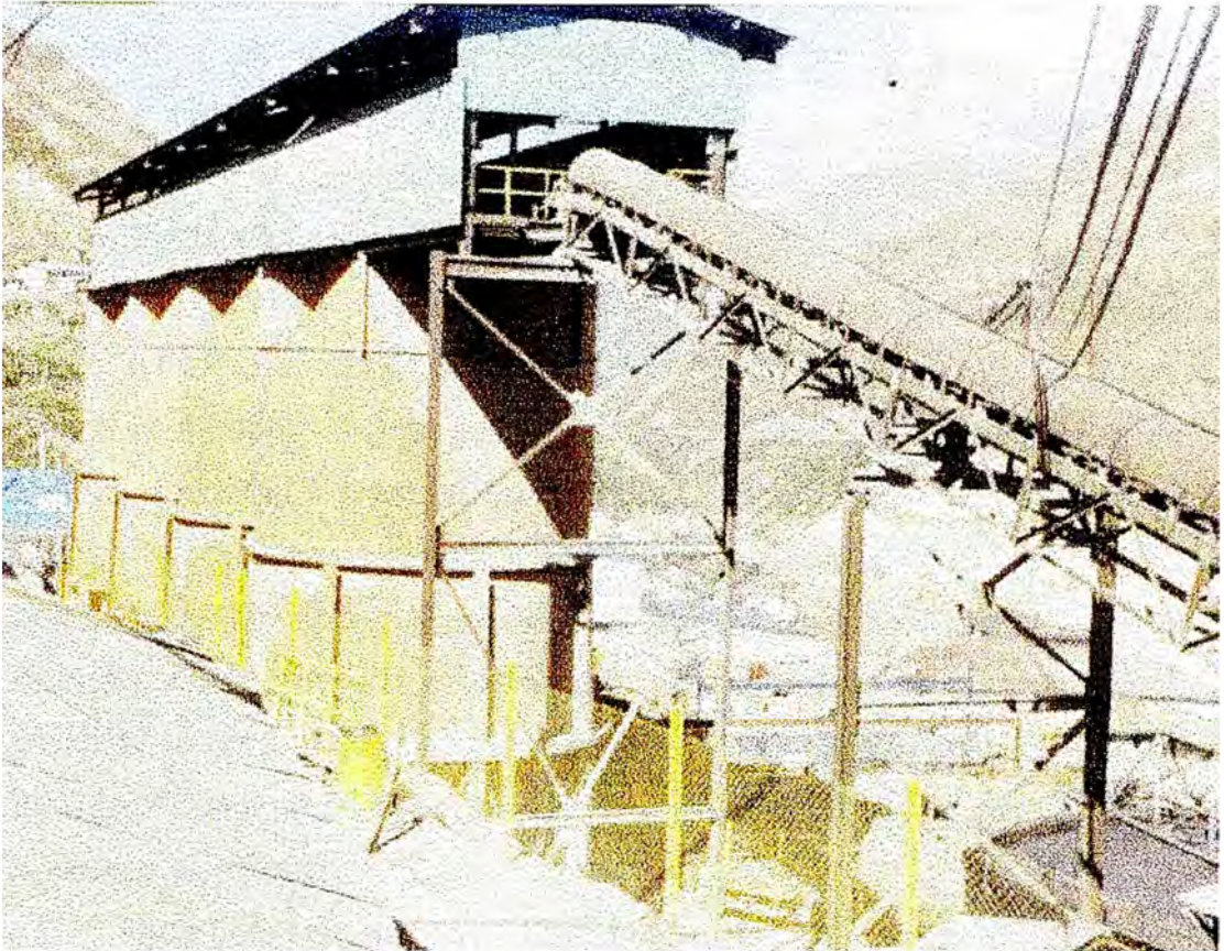
Fig. 4.- Vista de las tolvas de acumulación de mineral chancado
