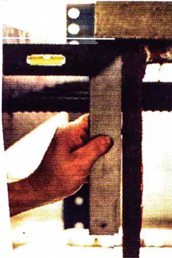
Foto N° 09.- Verificación de la pérdida de verticalidad de la columna después del colapso
