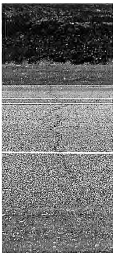
FIGURA 4. FISURAMIENTO POR BAJAS TEMPERATURAS
