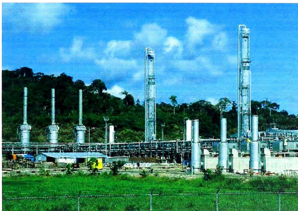
Foto N°4 Vista de los hornos Hot Oil y las Torres Deetanizadoras
