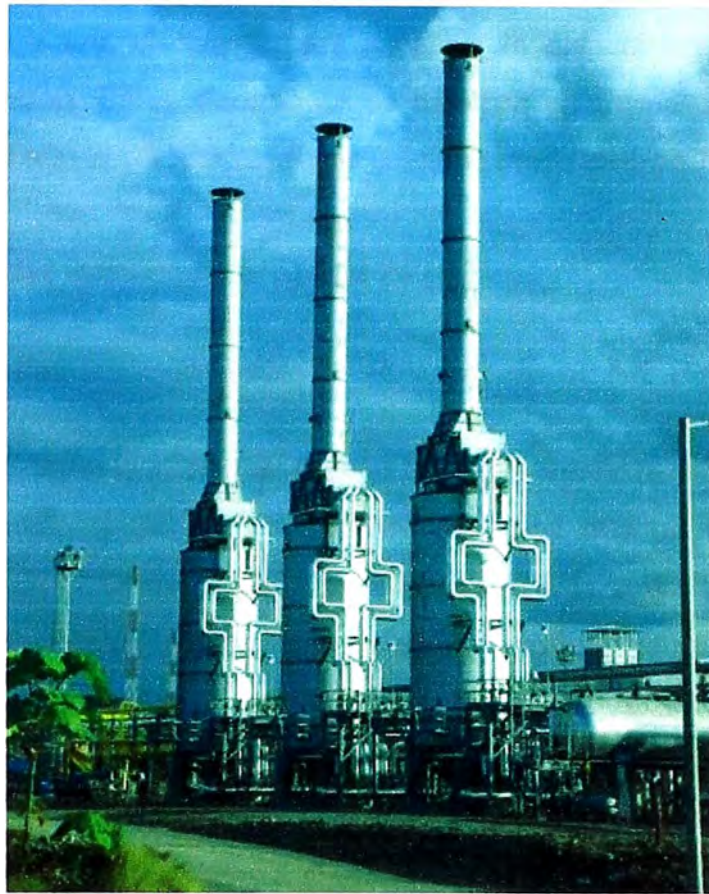
Foto N°3 Hornos Hot Oil de la Planta de Gas de Camisea
