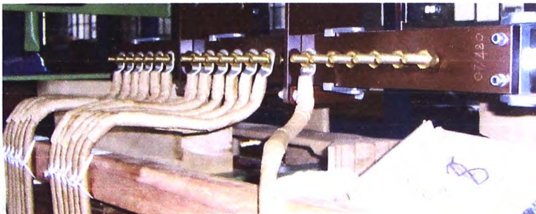
Figura 2.6 Conmutadores (Fuente: Propia)
