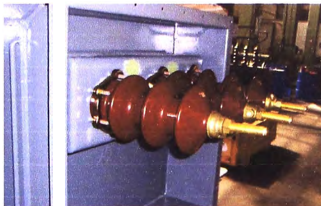
Figura 2.13 Aisladores de Media tensión (Fuente: Propia)
