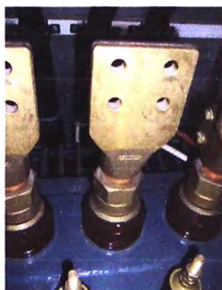
Figura 2.14 Aisladores de Baja tensión (Fuente: Propia)
