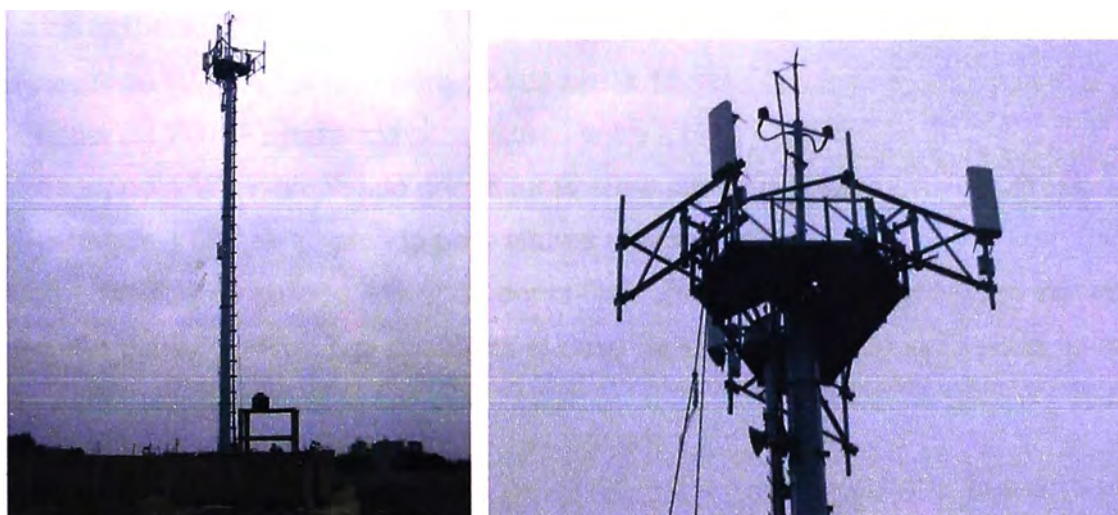
Fig. 2.15. Implementación de Sistema Radiante – 3 Sectores
