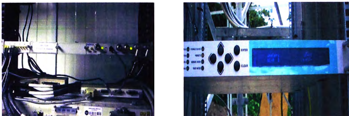
Fig. 2.20. Implementación Link MW (Izq) y Link SAT (Der)
