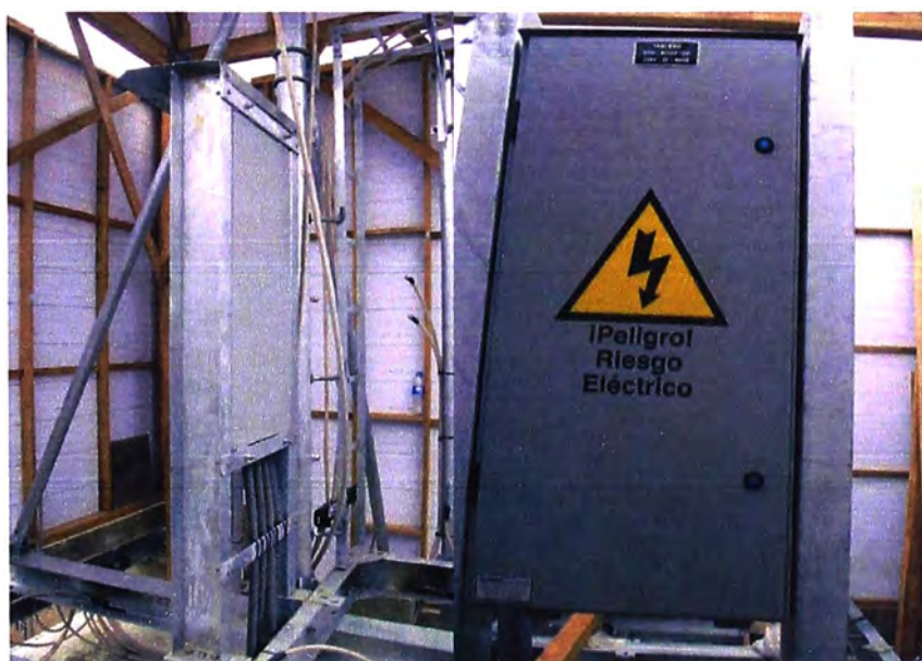
Fig. 4.21. Tablero de Energía instalado y cableado
