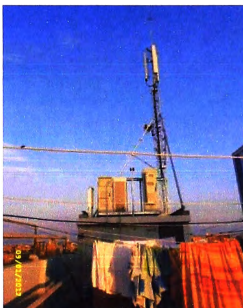
Fig. 2.10. Estaciones Rooftop con Licencia
