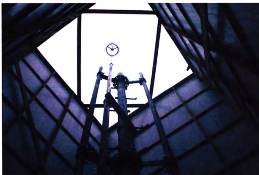
Fig. 4.20. Mástil y Pararrayos instalados en cajón de PVC
