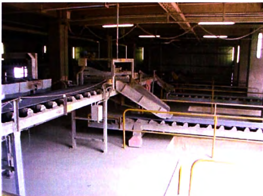
Figura 1.29 Sistema de transporte de sacos a camiones (Fuente: Cementos Pacasmayo)
