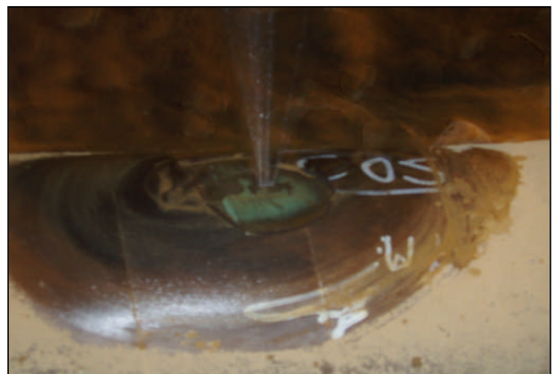
Fig. 20.- Verificación de tubería picada
